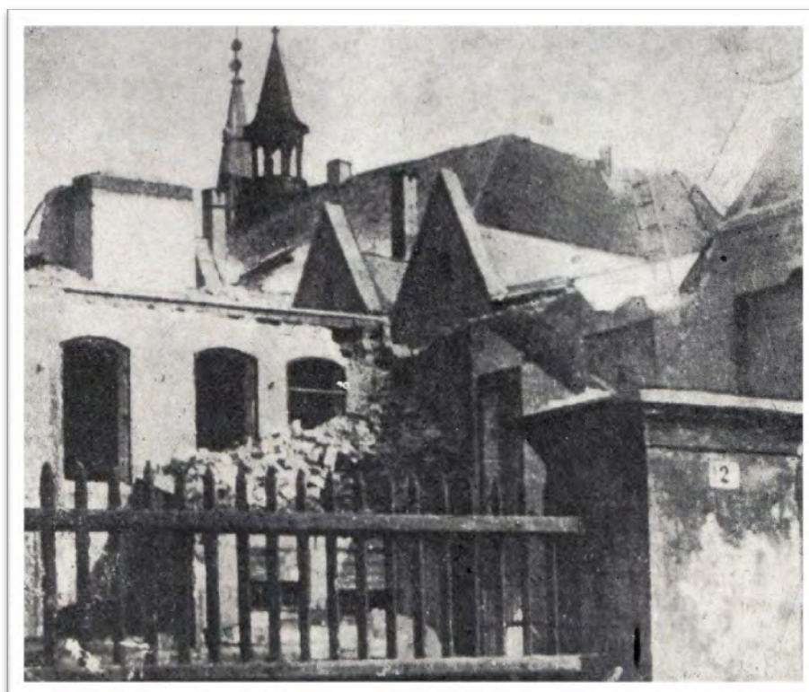
Fotografie postupu demolice jižního křídla zámeckého areálu, ve kterém fungoval pivovar (snímek z r. 1946, OM Chomutov).
