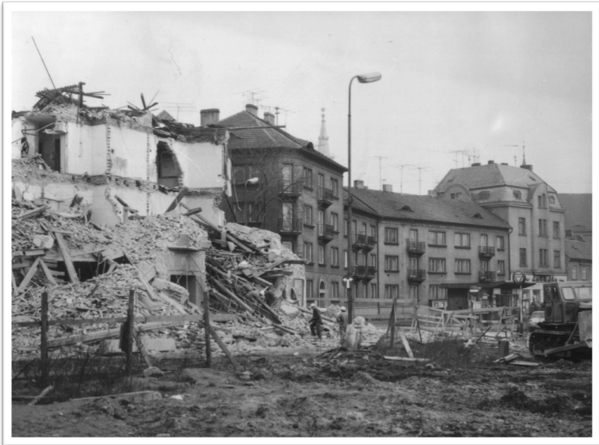
Fotografie z průběhu demolice Českého domu z r. 1976 (OM Chomutov). V pozadí domy severní strany Žižkova náměstí.
