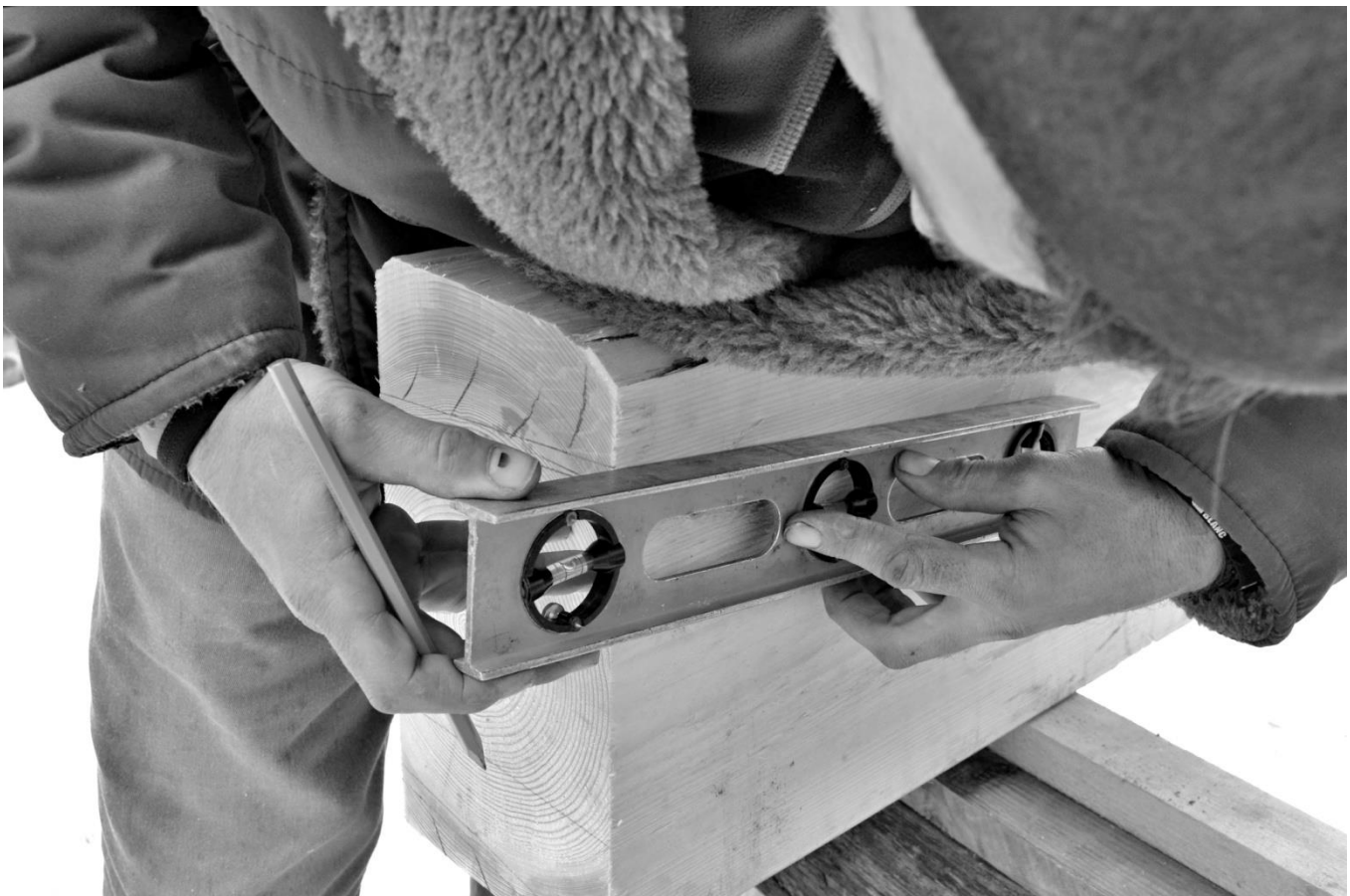
35 Nastavený sklon, odpovídající měření u spodní hrany dosedací plochy původního nárožního spoje, přeneseme na opačnou stranu nové srubnice, v návaznosti na společnou linku na čele. To samé pak uděláme i u sousední plochy.
