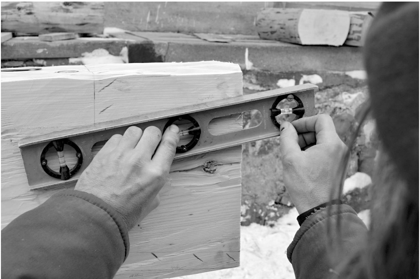
34 Druhé dvě linky odpovídající měření u spodních hran dosedacích ploch původního nárožního spoje přeneseme na jejich pozici na odvrácené ploše trámu. Podle sklonu linky nastavíme libelu.
