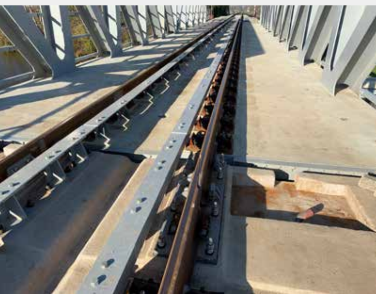
▲ Obr. Šikmý styk kolejnic na železničním mostě (zdroj: STRABAG Rail a.s.)
