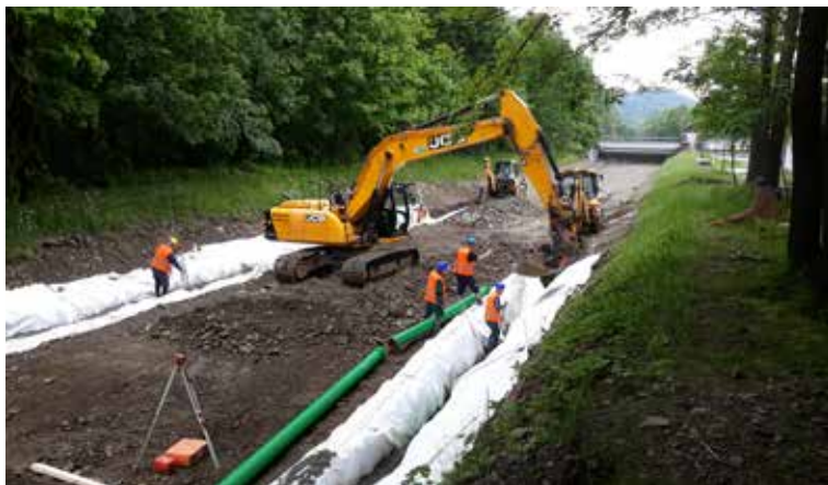
▲ Přivaděč km 0,000–0,337 – pokládka drenážního potrubí DN200 SN12 v rýze po obou stranách koryta přivaděče
