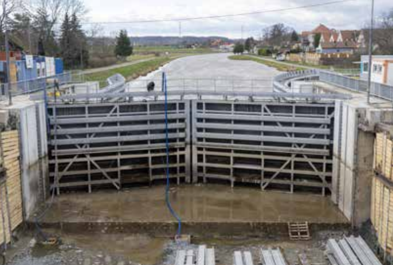
▲ Pohled na uzavřená vrata nového povodňového uzávěru plavebního kanálu situovaného při mostě 003.C (zdroj: STRABAG Rail a.s.)
