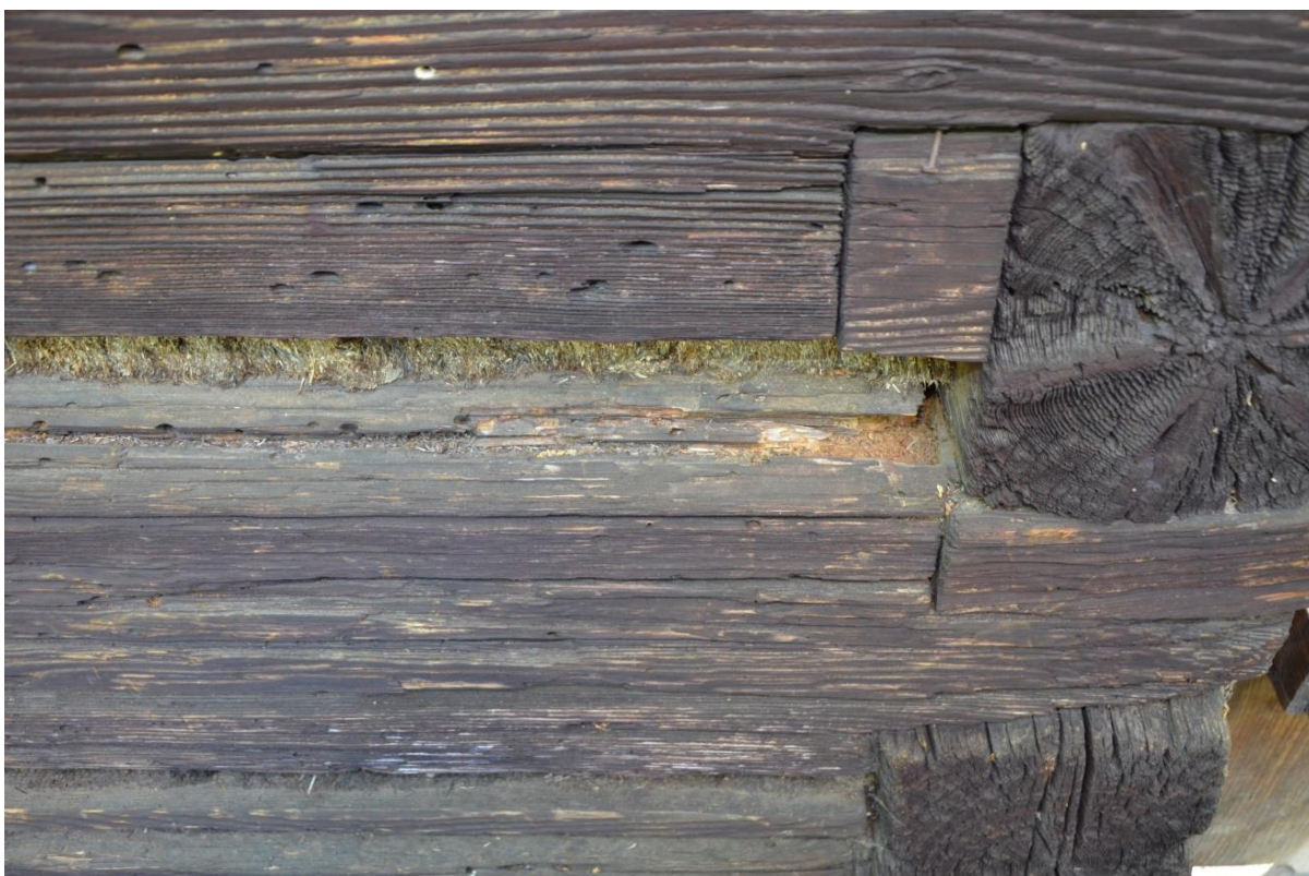
Obr. 22 Chalupa z Velkých Karlovic – Miloňova, detail poškození výsušné trhliny
