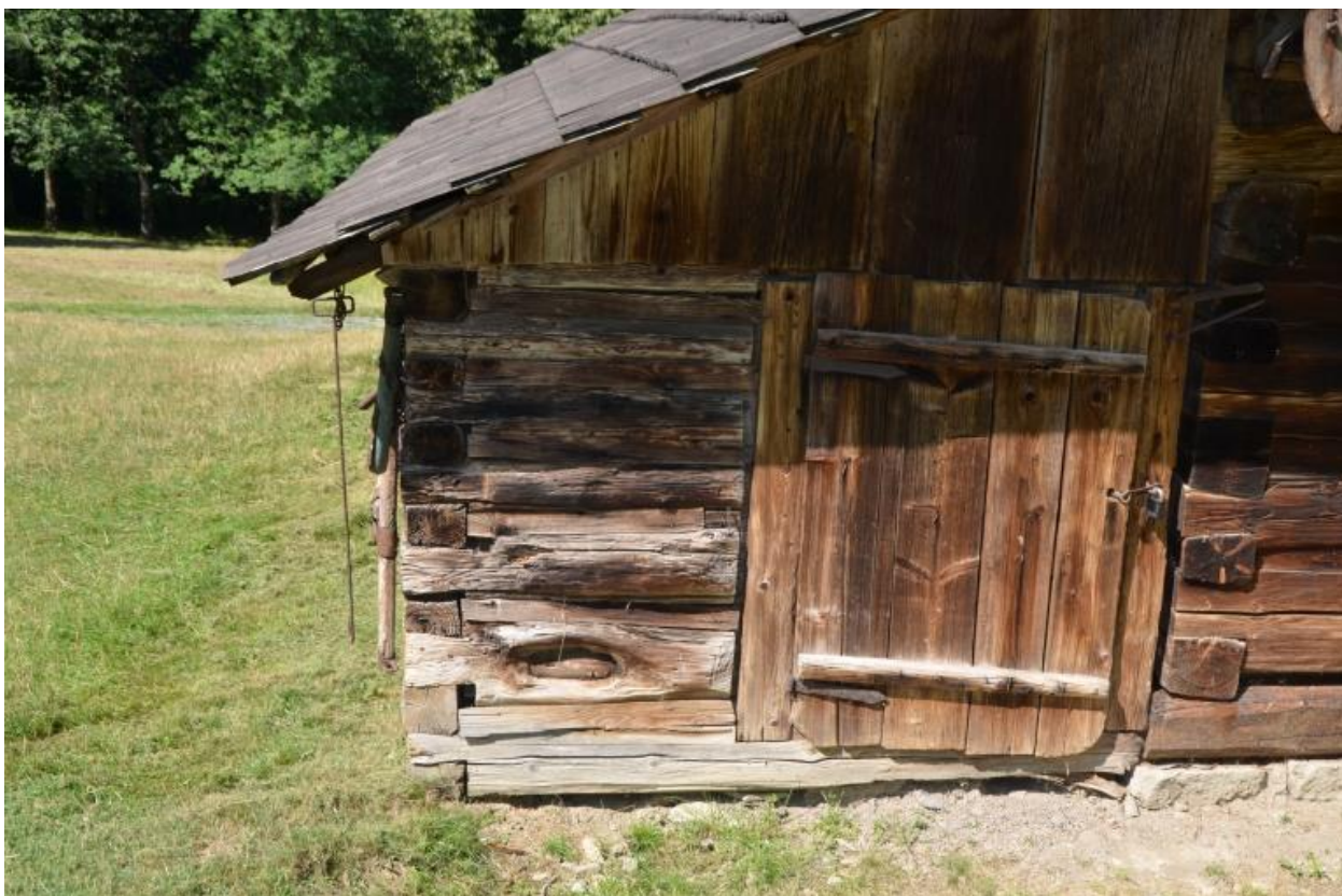
Obr. 30 Hospodářská usedlost z Velkých Karlovic – Podřatého, chlév, poškozená východní stěna roubení
