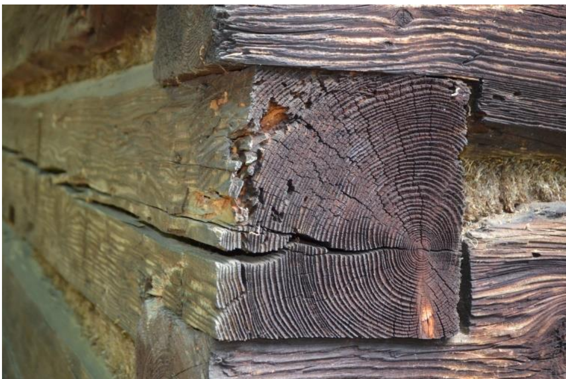
Obr. 26 Chalupa z Velkých Karlovic – Miloňova, detail poškození příčného řezu trámu
