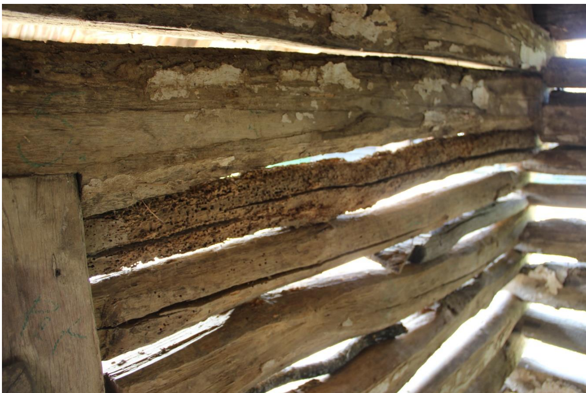
Obr. 41 Komora z Biskupic, vstupní okapová stěna s dvěma horními srubnicemi poškozenými dřevokaznými škůdci, detail konsolidace vnitřní stěny kaseinovým mazem
