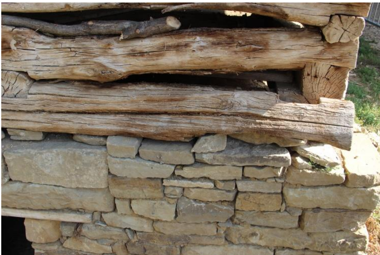
Obr. 35 Komora z Biskupic, poškozený prahový trám, kde zatékalo do masivní výsušné trhliny
