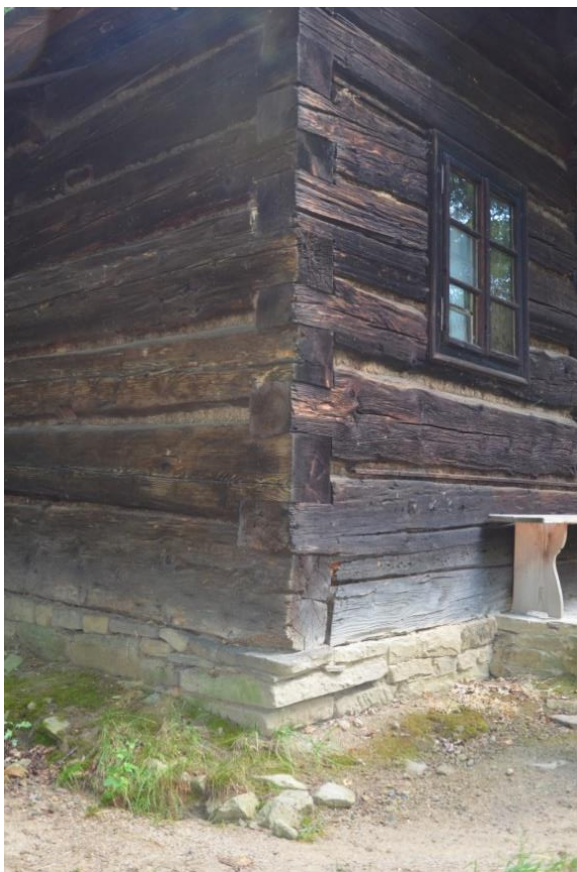
Obr. 25 Chalupa z Velkých Karlovic – Miloňova, Z štítová stěna, poškození příčného řezu
