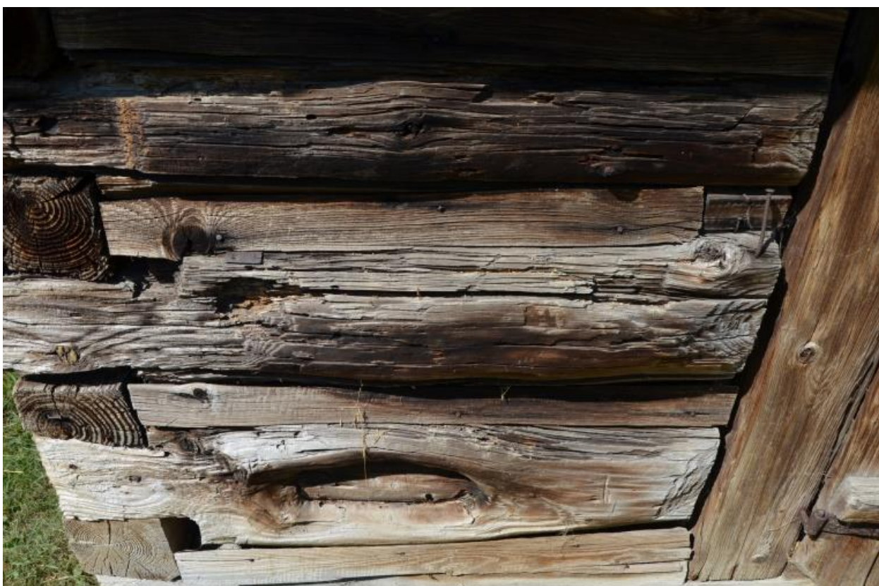
Obr. 31 Hospodářská usedlost z Velkých Karlovic – Podřatého, chlév, detail poškozeného roubení
