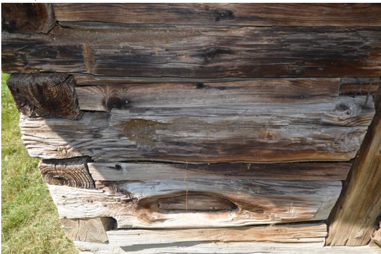
Obr. 33 Hospodářská usedlost z Velkých Karlovic – Podřatého, chlév, detail po vytmelení kaseinovým tmelem
