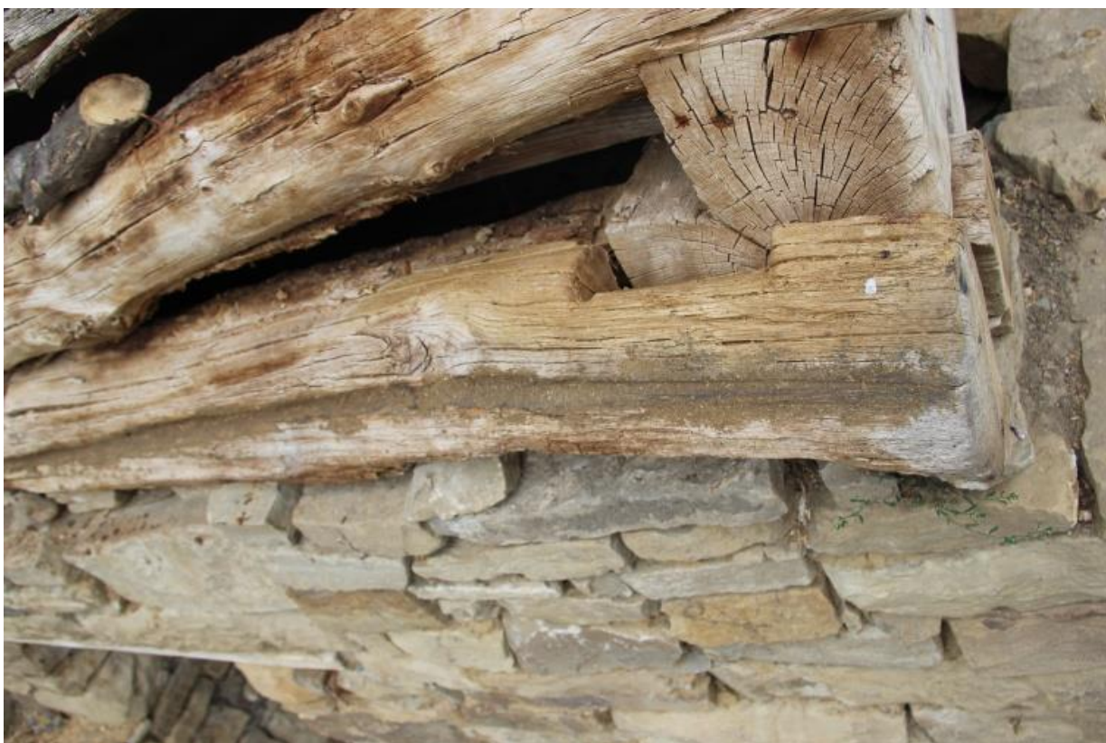
Obr. 36 Komora z Biskupic, poškozený prahový trám po vytmelení
