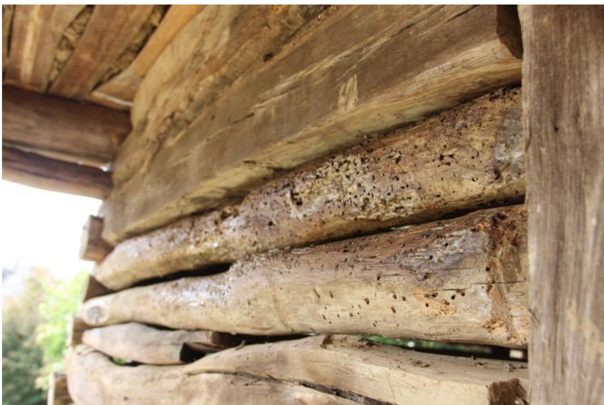
Obr. 40 Komora z Biskupic, vstupní okapová stěna s dvěma horními srubnicemi poškozenými dřevokaznými škůdci, detail konsolidace kaseinovým mazem
