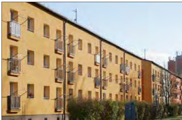
73. Sušáky jednotné konstrukce byly v rámci regenerace domu osazeny na všech balkonech. Materiálově i formátově korespondují se zábradlím, problém je orientace fasády do ulice.
