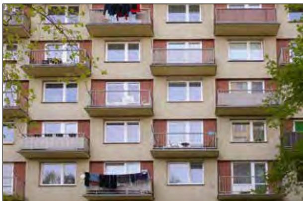
71. Desetipatrový malobytový dům v předpolí pivovaru Pernštejn měl prádelnu i sušárnu, přesto je jeho osobitě plasticky členěné šachovnicově průčelí s barevnými upadlými poli narušeno ulajícím prádlem.
