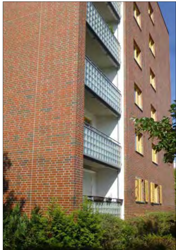
324. Fasády s kvalitním obkladem se nezateplují tak často jako omítané nebo režné panelové, a pokud ano, obklad lze aplikovat na zateplení. Trvanlivost je však patrně menší, než u aplikace na zdiwo či panel.
