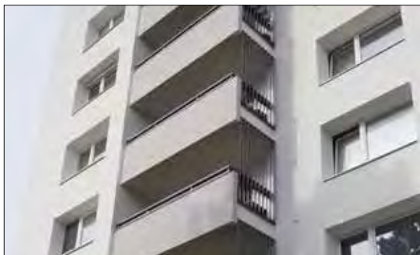
149. Obnovení mřížoviny na balkonech. Liberec, sídliště Králův Háj čp. 557, Aloisina výšina 54. 60. a 70. léta 20. století. Foto: Hana Řepková, 2017.
