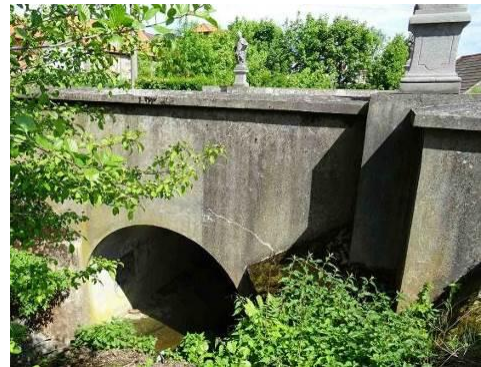
Obr. 89. Čimelice, 18. století trhlina mezi klenbou a poprsními zdmi
