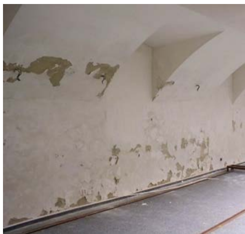
Foto 5: Dominantní transport vlhkosti do zdiva a kleneb přes dožilou rubovou izolaci. (autor: L. Balík)
