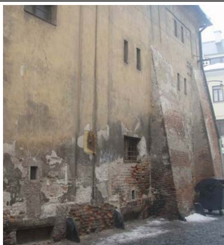
Foto 1: Kombinace vzlínající, odstříkující a dešťové vody, jež smáčí šikminy zdiva. (autor: L. Balík)
