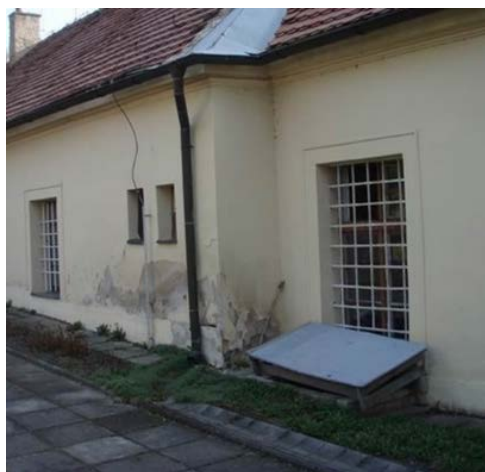
Foto 3: Přivádění vody přímo pod objekt z porušeného dešťového svodu. (autor: L. Balík)
