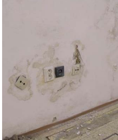
Foto 6: Vlhkostní poruchy způsobené sádkou pro fixaci elektroinstalace. (autor: L. Balík)
