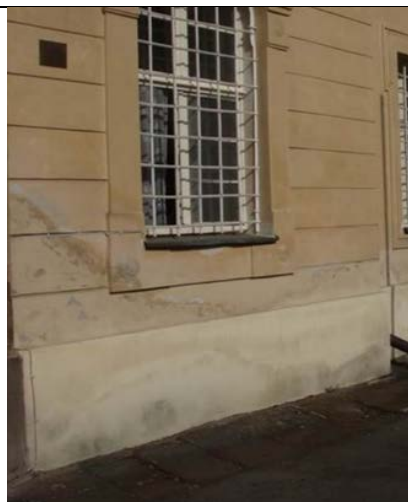
Foto 2: Vlhkostní klín narůstající při napojení zdiva na nasávkavý pískovcový portál hlavního vstupu. (autor: L. Balík)
