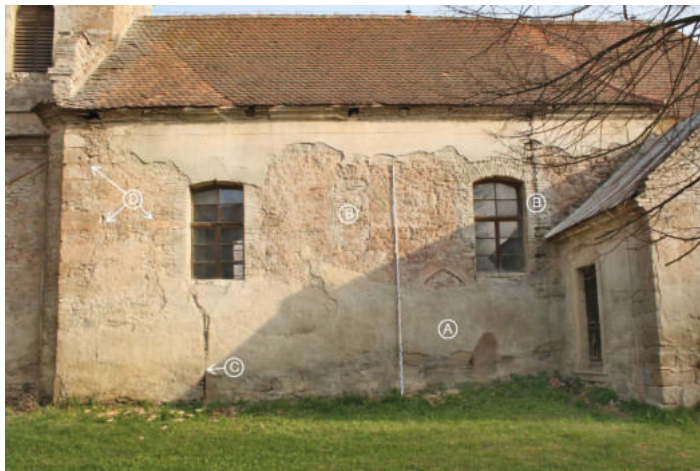
Čelní pohled na jižní průčelí lodi. A – středověký portál zazděný při rozšíření lodi roku 1788. B – dvojice středověkých okenních otvorů zazděných při rozšíření lodi a realizaci stávajících okenních otvorů roku 1788. C – vertikální spára určující původní délku středověké lodi s v patě dochovanými kvádry nárožního armování. D – středověké kvádry druhotně použité při prodloužení lodi v roce 1788. Foto: J. Skopec 2014.
