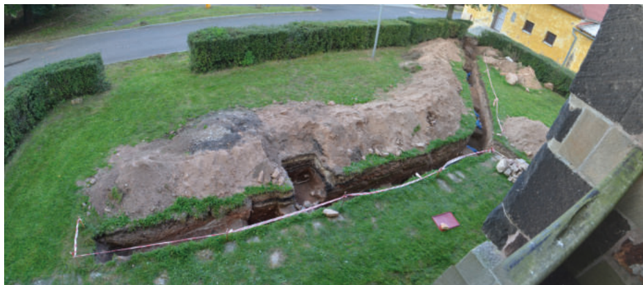
2.8 I plošně menší zásahy do terénu v okolí kostela mohou přinést důležité poznatky objasňující stavební a sídelní vývoj. Konkrétní příklad představuje záchranný archeologický výzkum prováděný při stavbě elektrické přípojky ke kostelu sv. Jakuba Většího ve Vroutku. Foto: archiv ÚAPPSZČ, v. v. i.
