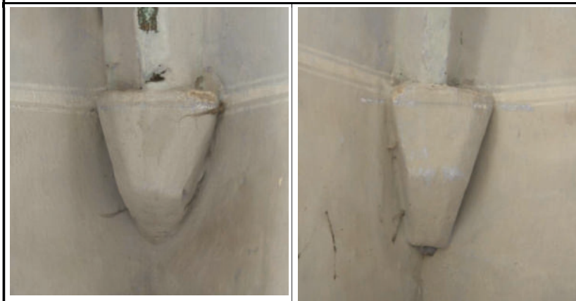
Detail jihovýchodní konzole klenby presbytáře. Foto: J. Skopec 2014.
