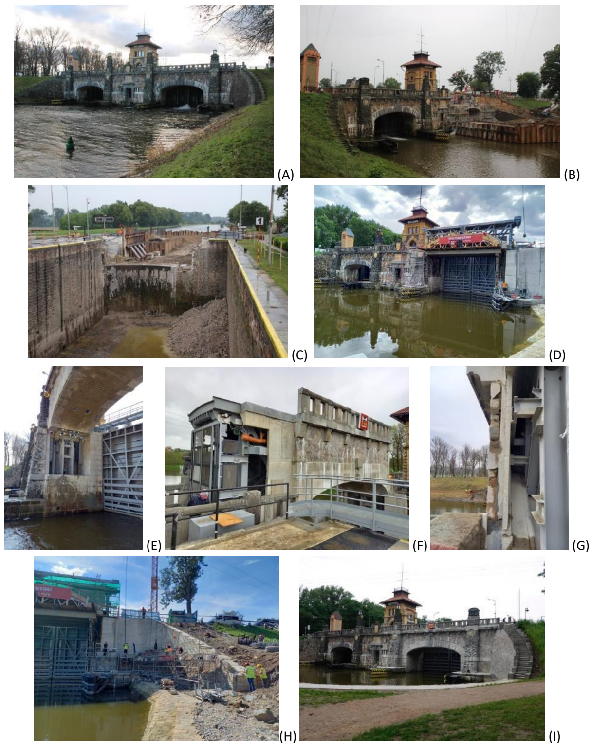
Obr. 5.4: Hořín – zdymadlo v průběhu rekonstrukce: (A) stav před přestavbou; (B) a (C) rozebírání původních konstrukcí a kamenných obkladů; (D) až (F) nová konstrukce zvedacího mostu a velké plavební komory; (G) a (H) osazování původního obkladu na novou železobetonovou konstrukci. Foto Otakar Hrdlička, 2021; (I) současná podoba zdymadla. Foto Michaela Ryšková, 2021.
