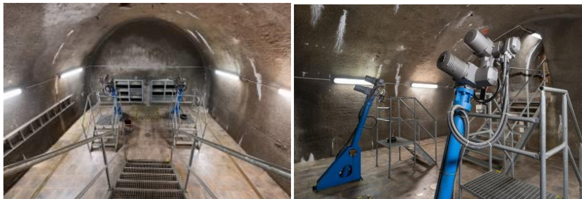
Obr. 4.10: Přehrada Pařížov (1909–1913) – ovládání provozních segmentových uzávěrů spodních výpustí DN1200 uložených v obtokové štolě. Foto Viktor Mácha, 2020.
