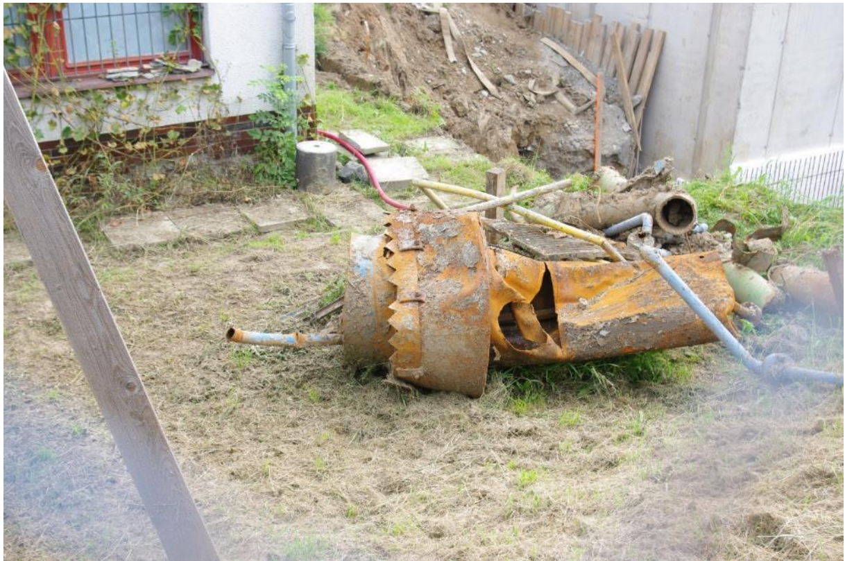
Obr. 5.28: Vystrojení dosazovací nádrže ČOV poškozené při rekonstrukci čistírny. Foto Miloš Rozkošný, 2021.
