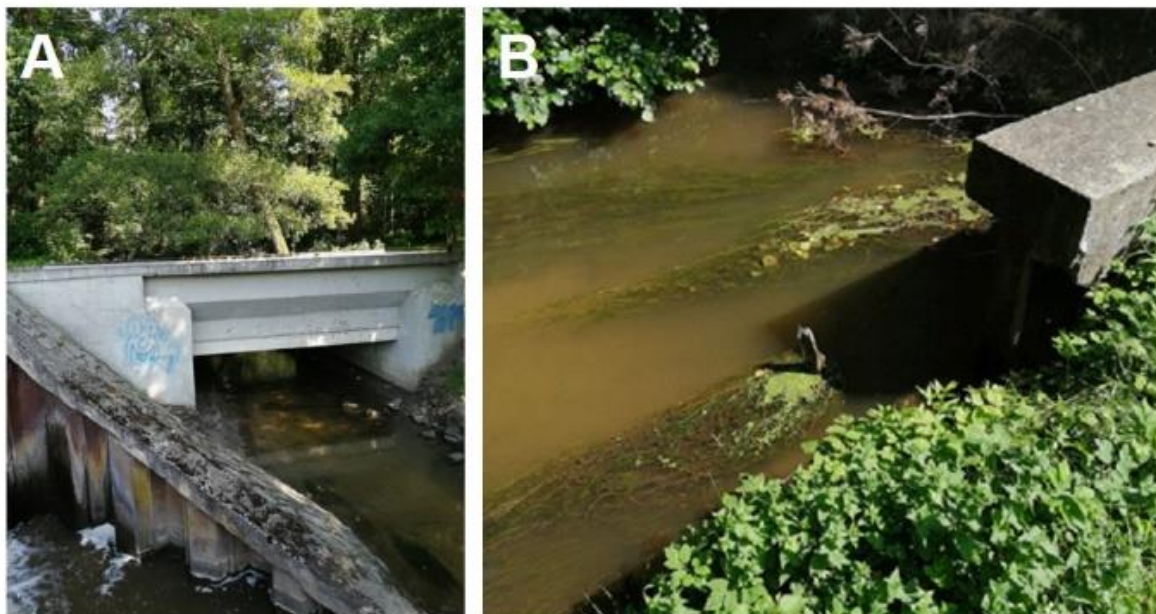
Obr. 4.92: Semínský akvadukt na Opatovickém kanále: (A) stav po rekonstrukci; (B) pozůstatky starých dřevěných prvků. Foto David Honek, 2020.
