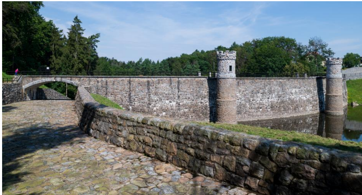
Obr. 4.11: Přehrada Pařížov (1909–1913) – přelivná hrana bočního bezpečnostního přelivu a spadiště, které za mostem navazuje na kaskádu. Foto Viktor Mácha, 2020.
