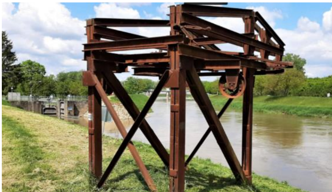
Obr. 4.87: Zbytky lodní lanovky pro křížení Baťova kanálu s Moravou u Vnorov. Foto archiv VUV, 2012.
