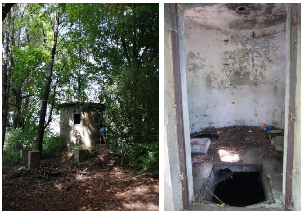
Obr. 5.27: Selmice (nedaleko areálu hřebčina v Kladrubech nad Labem) – zbytky objektu historické čerpací stanice závlahové vody. Foto David Honek, 2021.
