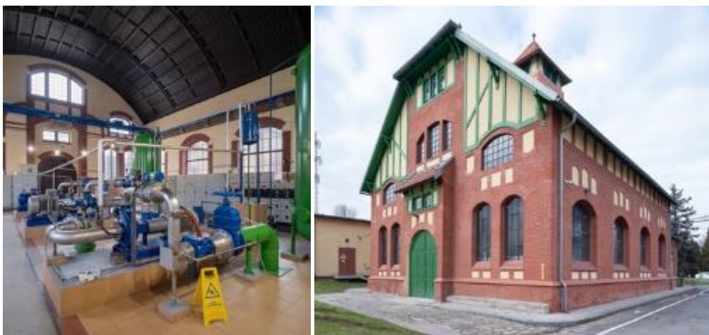
Obr. 5.2: Ostrava – úpravna vody, strojovna. Foto Viktor Mácha, 2019.
