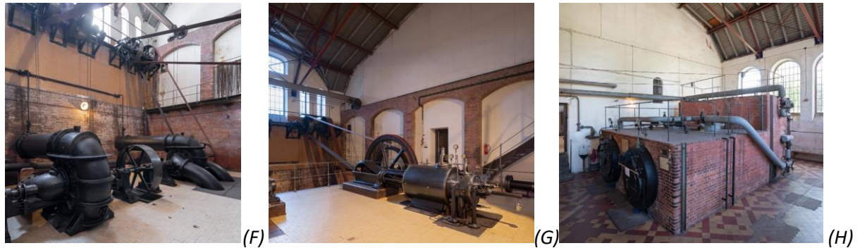
Obr. 4.269: Praha-Bubeneč. Stará čistírna odpadních vod. Legenda: (A) celkový pohled; (B) stavidlový uzávěr na stoce; (C) lapák písku; (D) kotelna a uhelna pro výrobu teplé vody a vytápění (původně prostor nádrží na vápennou vodu); (E) česle; (F)–(G) strojovna parních strojů; (H) kotelna. Foto Viktor Mácha, 2019.
