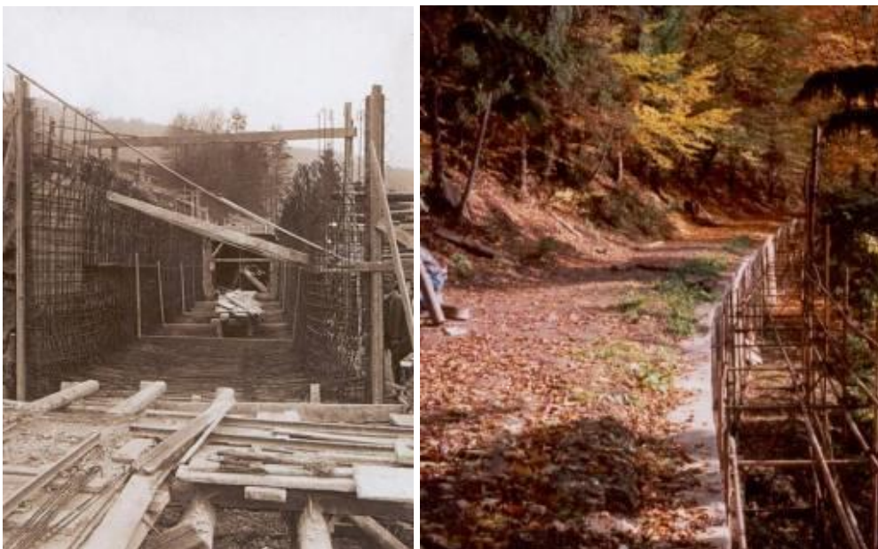
Obr. 4.149: MVE Spálov – železobetonový přívodní kanál: (A) postup armování v roce 1925. Převzato z: VČE, 2000; (B) pohled ze stropu kanálu v roce 1998 během rekonstrukce. Foto vpravo VUT v Brně, FAST, 1998.
