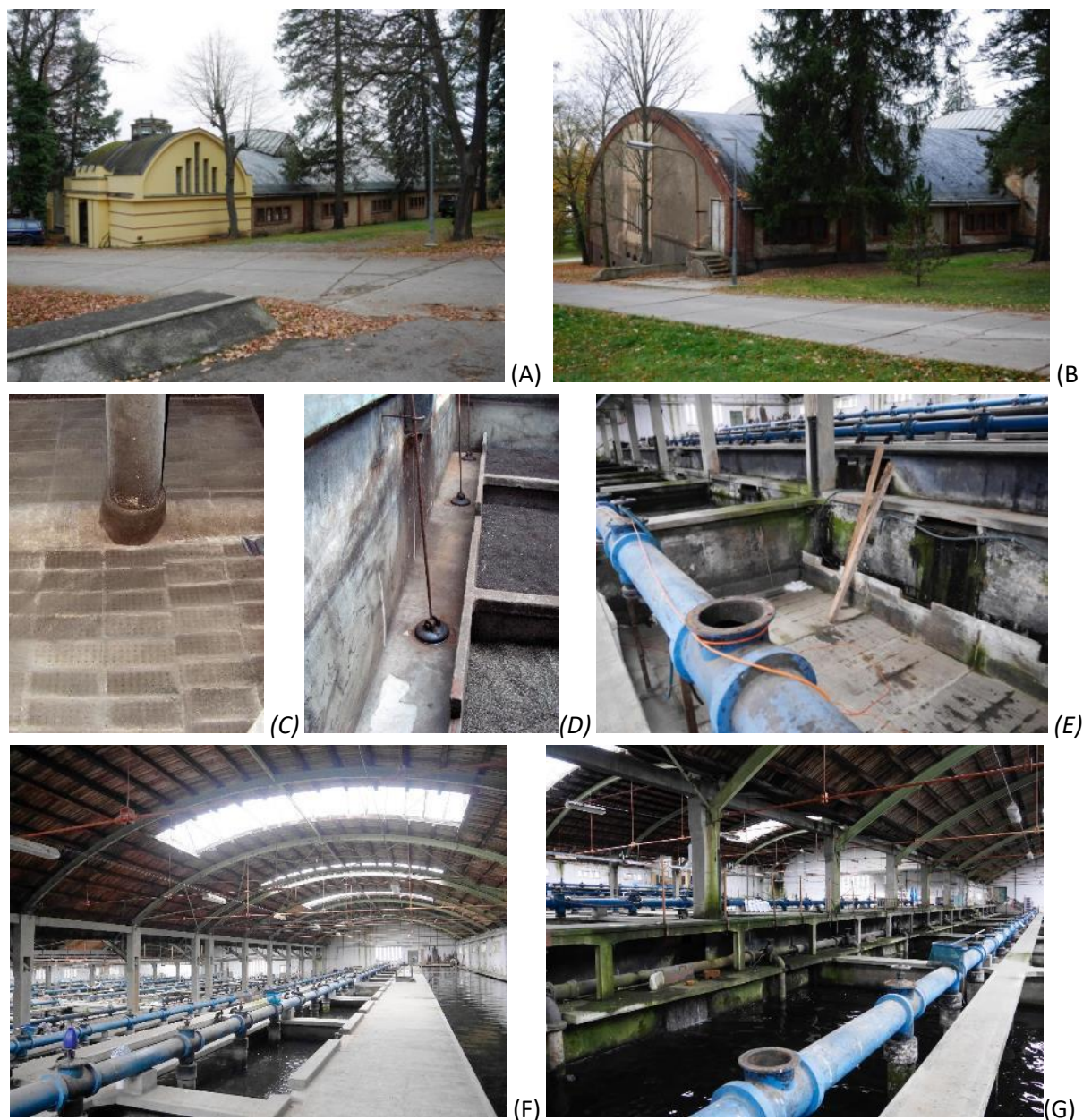
Obr. 5.20: Plzeň – budova Puech-Chabalovy filtrace: (A) hlavní vstup a nejvýše položená severovýchodní hala; (B) nejnižše položená jihozápadní hala; (C) a (F) dokumentace z průběhu čištění jednotlivých nádrží; (E) a (F) celkové pohledy za současného provozu. Foto Jan Mikač, 2015 a Michaela Ryšková, 2020.
