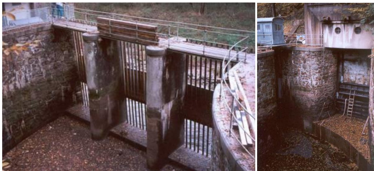
Obr. 4.143: Derivační MVE Spálov – vtokový objekt, stav bez vody v době opravy v roce 1998. Foto VUT v Brně, FAST, 1998.
