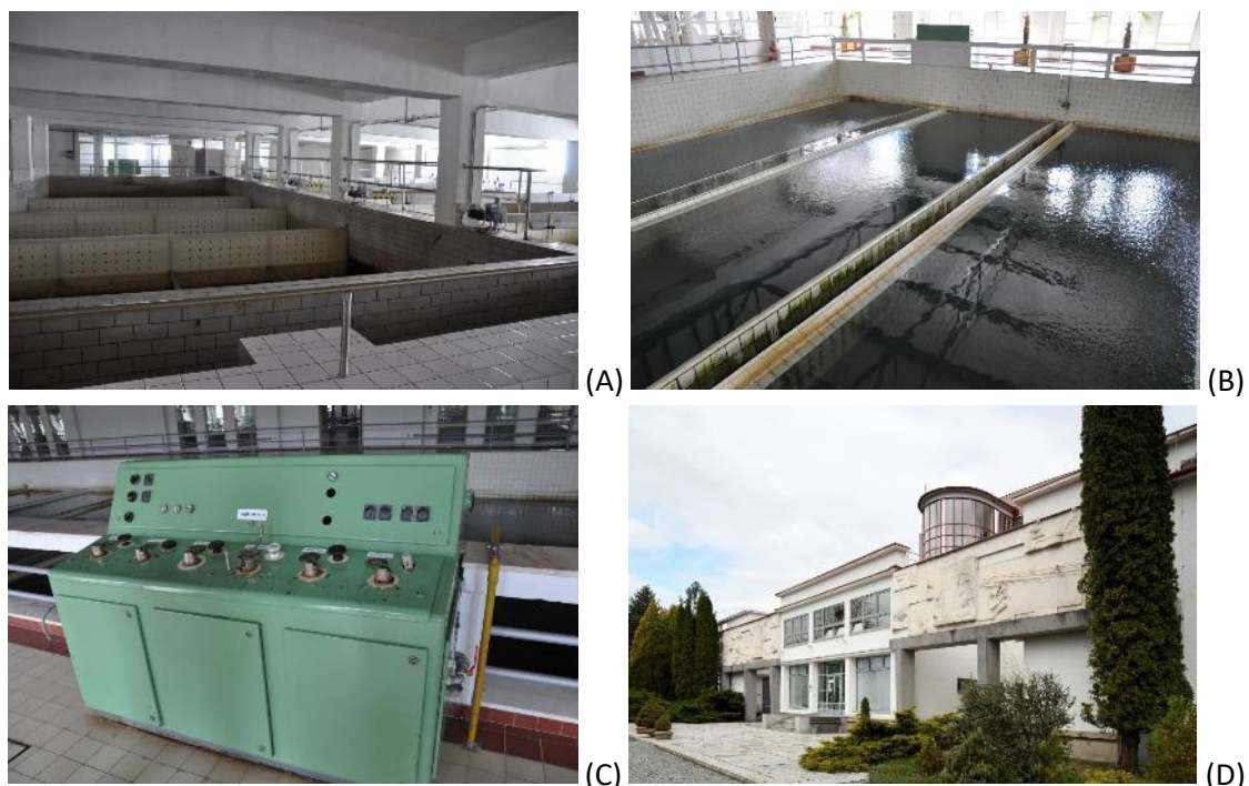
Obr. 4.232: Vítkov-Podhradí – úprava vody: (A) hala filtrace; (B) filtrační nádrže; (C) původní ovládací panel. Foto David Honek, 2019; (D) reliéf (více fotografií v kapitole 3.2, hodnota uměleckohistorická). Foto Roman Polášek, 2019.
