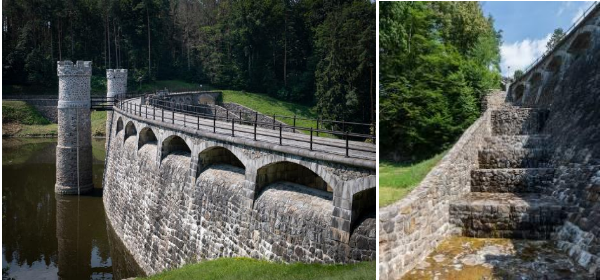
Obr. 4.12: Přehrada Pařížov (1909–1913) – vlevo pohled na korunový bezpečnostní přeliv z návodní strany, vpravo pohled ze vzdušní strany na kaskádu korunového přelivu. Foto Viktor Mácha, 2020.
