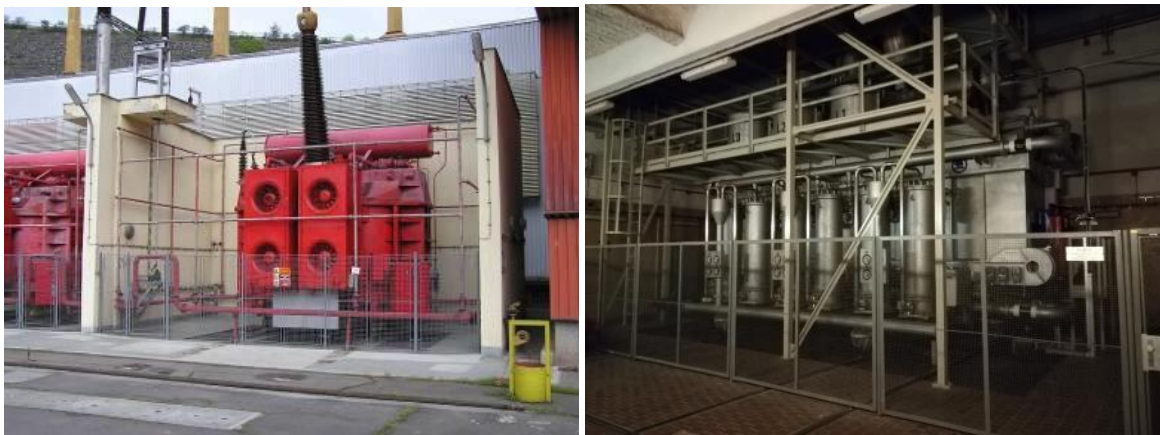
Obr. 4.180: Blokové transformátory: (A) PVE Dalešice; (B) PVE Dlouhé Stráně. Foto VUT v Brně, FAST, 2019.
