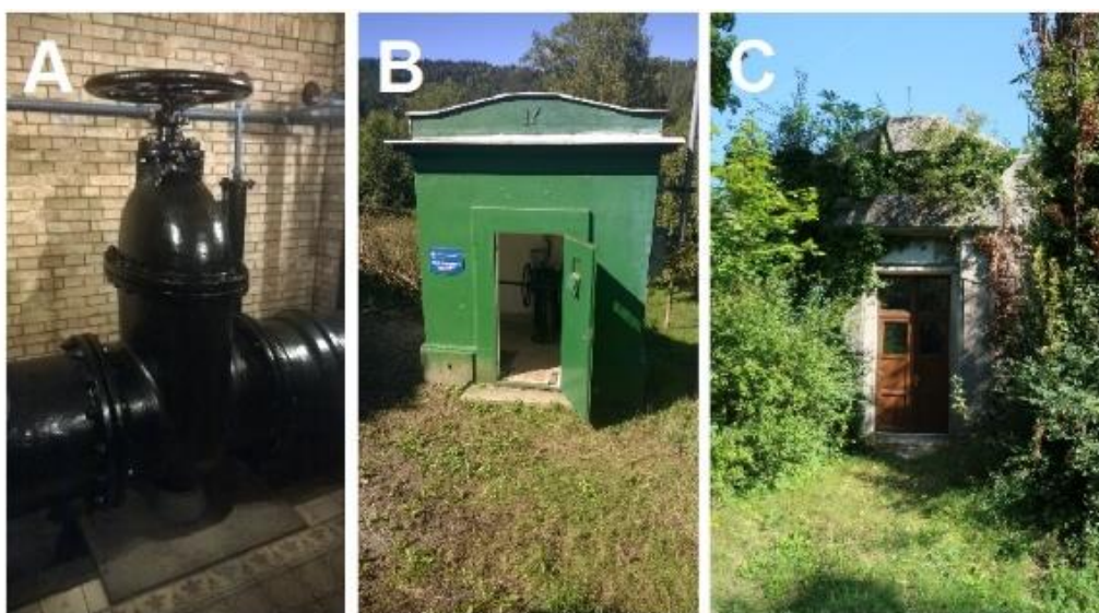
Obr. 3.3: I. březovský vodovod: (A) manipulační uzávěr vody; (B) šoupátková komora; (C) vstup do zemního vodojemu Holé Hory 2; litinový dálkový přivaděč pitné vody o délce 57 km, který se zachoval v původním provedení, vyjma modernizace dálkového ovládání strojního vybavení. Foto David Honek, 2019.
