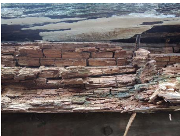
Obr. 18 Poškozený trám č. 7 v místě severního zhlaví
