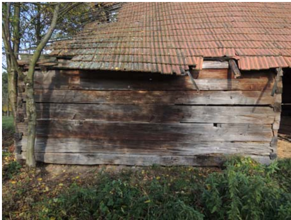
Obr. 4 Jižní stěna západní části stodoly
