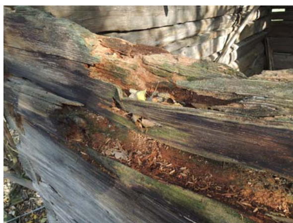
Obr. 19 Poškozený trám č. 8 v místě severního zhlaví
