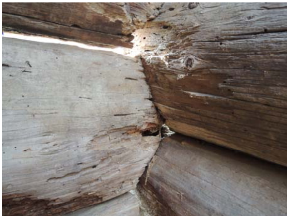
Obr. 14 Poškozený trám č. 2 v místě západního zhlaví
