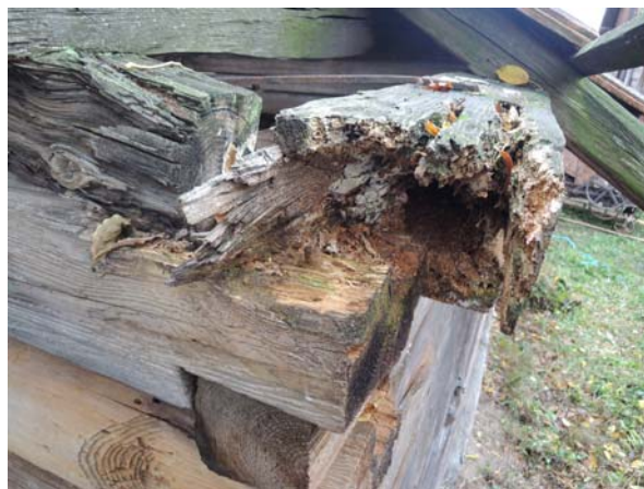
Obr. 17 Poškozený trám č. 8 v místě západního zhlaví
