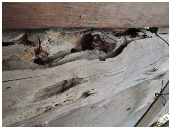
Obr. 15 Poškozený trám č. 5 v místě západního zhlaví
