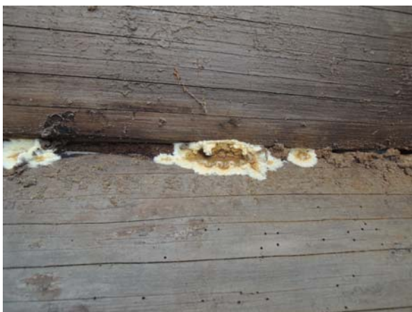
Obr. 16 Poškozený trám č. 6 v místě západního zhlaví
