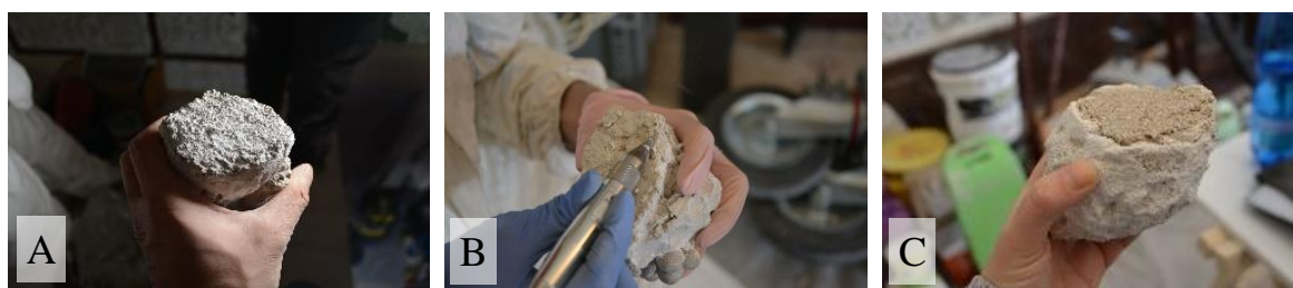
Obrázek 17: Úpravy transferovaných tvarů před zpětným osazením (A). Odstranění zbytků původní lepicí malty (B) a doplnění jádrové malty (C).
