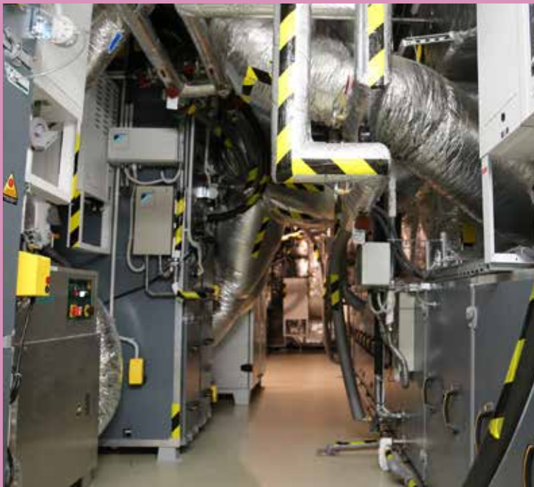
Klimatizace v Centrálním depozitáři v Litoměřicích
