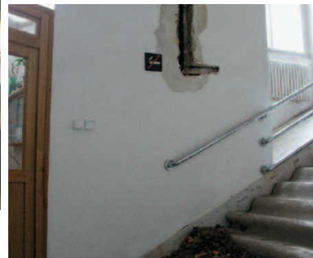
havárie stoupačky na hlavním schodišti 22. 8. 2005
