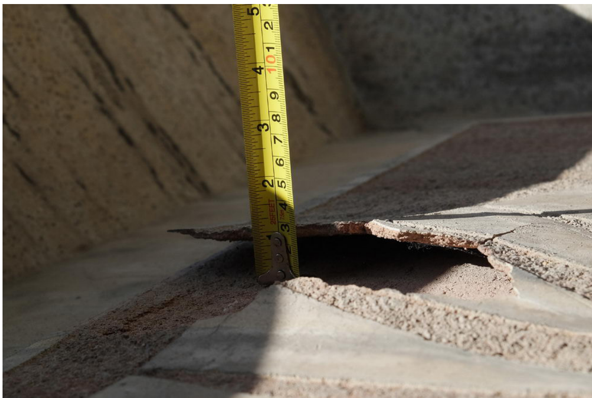
Obr. 15: Brno, Venhudova ulice. Detail stavu před restaurováním – boční pohled na odlupující se omítkové vrstvy
