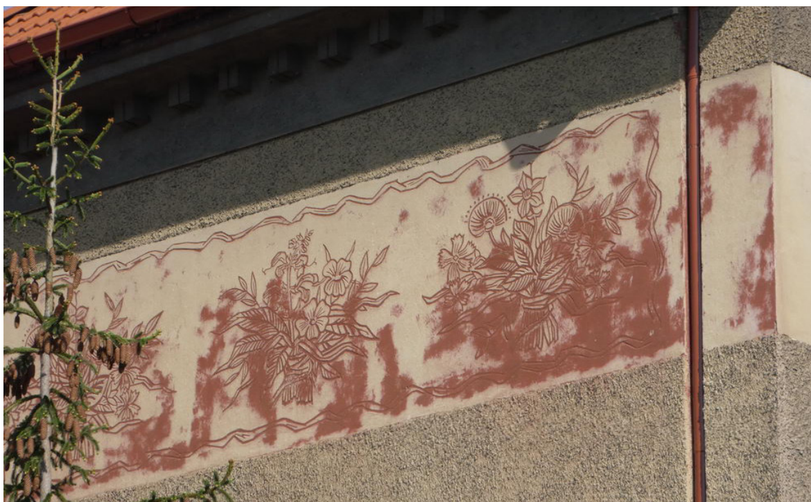
Obr. 4: Odolena Voda. Detail sgrafita s částečně vymytým intonacem biancem
