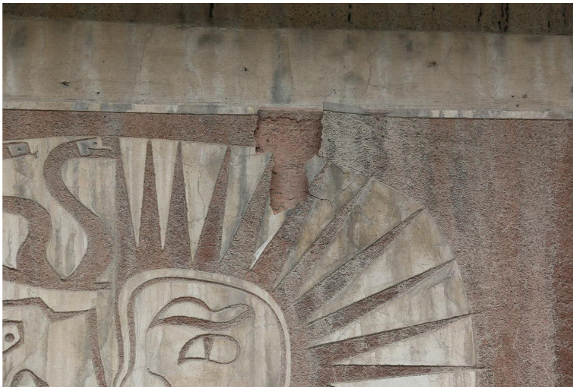
Obr. 14: Brno, Venušova ulice. Detail stavu před restaurováním – odlupující se omítkové vrstvy a lokální odpadnutí omítky
