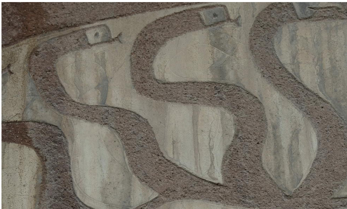
Obr. 5: Brno, Venhudova ulice. Detail stavu před restaurováním – znečištění povrchu sgrafita
