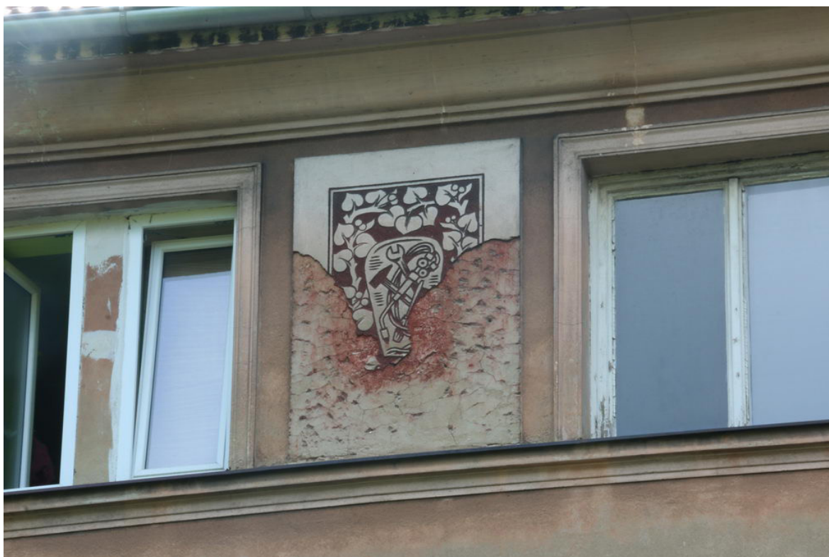
Obr. 2: Opava, Zápala ulice. Velká část omítky se sgrafitovým motivem se uvolnila od podkladu a odpadla
