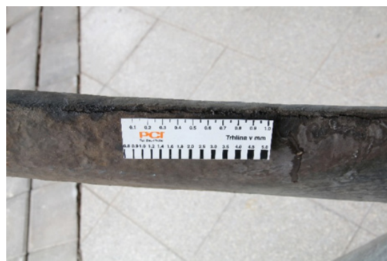
Obr. 7: Prasklina ve vrchní vrstvě laminátu
