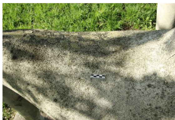
Obr. 14: Silné biologické znečištění povrchu laminátu
