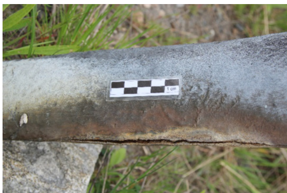
Obr. 13: Oblast kolem praskliny na patce sochy zabarvený korozními produkty ocelové výztuže
