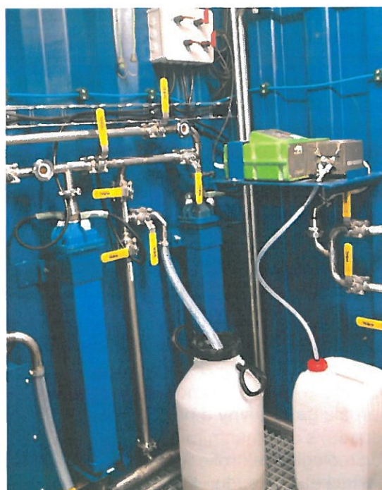
Obr. 1 Pohled na elektrokoagulační cely.
