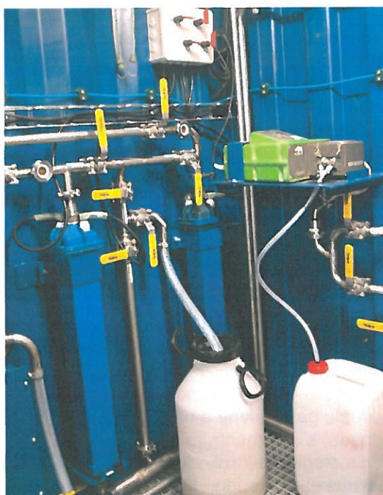
Obr. 1 Pohled na elektrokoagulační cely.
