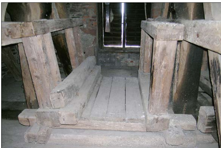
Havlíčkův Brod, kostel Nanebevzetí P. Marie. Dřevěný hever, kterým byl zvedán zvon z ložisek, aby mohla být provedena kontrola a údržba (pravděpodobně 18. stol.). Do válců v postranních dílech byly napříč zasazeny trámy s čepy a tím vznikla pevná konstrukce. Pomocí páky vsunuté do otvorů ve válcích se závoity v dolní části byly otáčením válců příčné trámy vyzvednuty, dosedly na dolní okraj zvonu a pak zvedly i zvon.
