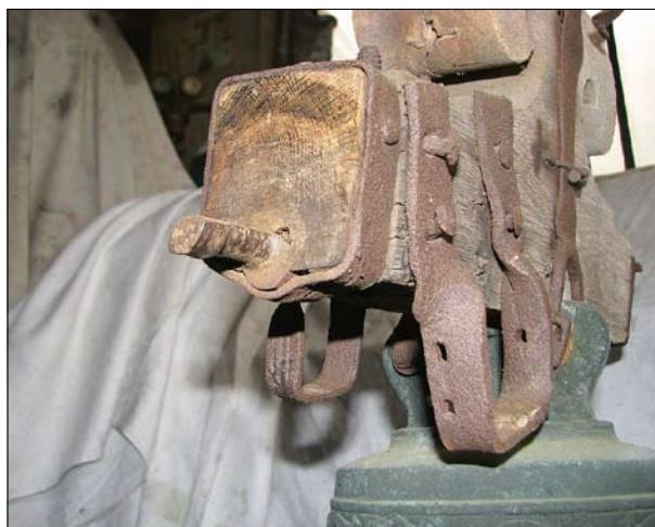
Vlčkov u Čakova, okr. Benešov, zvon z r. 1801. Mimořádně opotřeбенý čep zvonové hlavy. Skutečný stav lze zjistit po svěšení zvonu (foto P. Vácha, 2012).
