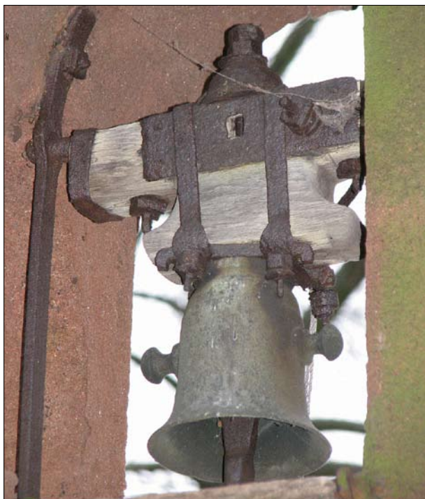
Smilovice, okr. Kutná Hora. Náhrada rekvirovaného zvonu hmoždířem, upevněným v překocené hlavě původního zvonu. Náhražka zvukově naprosto nevyhovující (foto P. Vácha, 2012).
