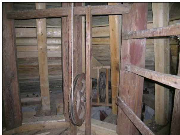
Osov (Skřípel), okr. Beroun, kostel sv. Jana Křtitele. Vedení provazu přes dřevěná kola – zvoní se mnohem snadněji než při vedení přes kladky (foto P. Vácha, 2005).
