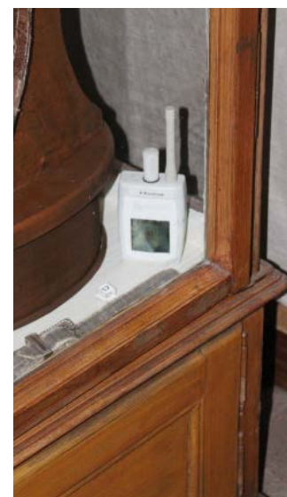
Obr. 47 Čidlo teploty a RV umístěné uvnitř historické vitríny
