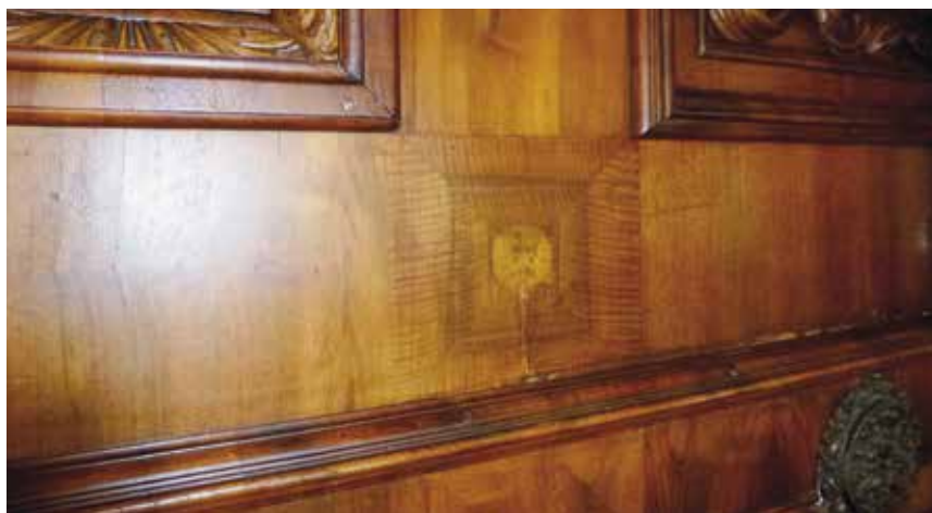
Dřevěný obklad ztmavlý dlouhodobým osvitem, v kazetě světlejší kulatá stopa po talíři, který zde byl instalován
