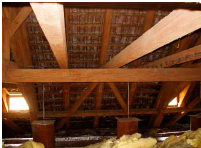
Obr. 3: Krov Nosticovy haly připravený k mykologickému průzkumu, odkrytá zhlaví trámů
