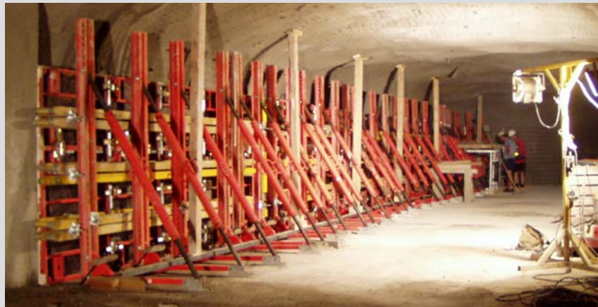
Projekt „Realizace uzavření komor v úložišti Richard“, výstavba vnitřní stěny hydraulické klece.
