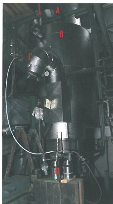
b) foto generátoru i s odběrovým místem pro stanovení obsahu dehtu v plynu za generátorem a horkým filtrem
