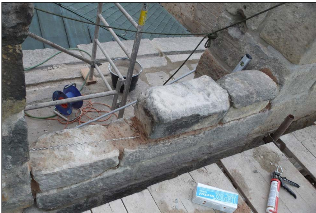
21) Hrad Kost, severní hradba jádra hradu, detail zpevnění části zdiva pomocí Helifixu (foto T. Rafl 2012).
