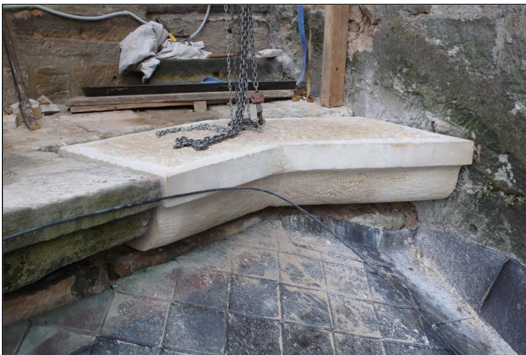
20) Hrad Kost, severovýchodní hradba jádra hradu, detail výměny bloku ochozu (foto T. Rafl 2012).
