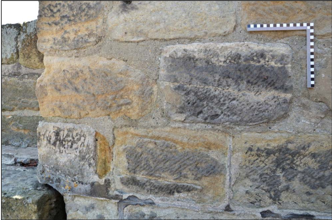
14) Hrad Kost, jižní hradba jádra hradu, vnitřní strana, pohled od severozápadu, stav po očistění. Detail novodobého, převážně cementového spárování, dole s vyrýsovaným kvádrováním (foto M. Panáček 2009).
