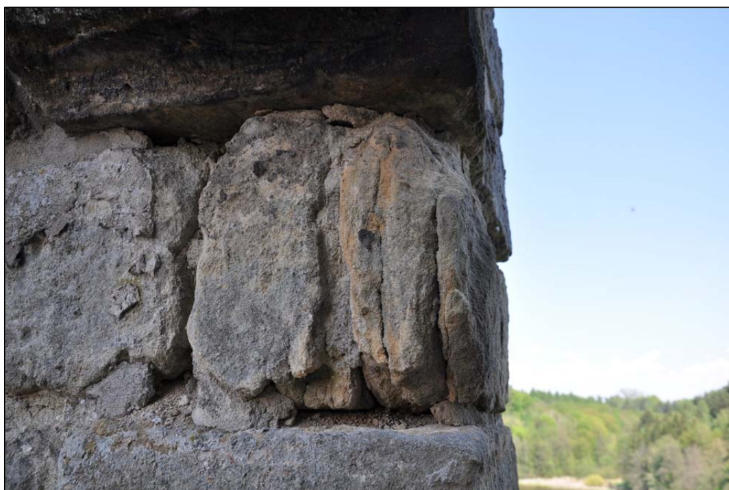
22) Hrad Kost, severovýchodní hradba jádra hradu, 2. stínka od jihu, vnitřní strana, pohled od jihu, stav před obnovou. Detail kvádrů s krakorcovým hákem se sedimentačními vrstvami záměrně osazenými ve svislém směru (foto M. Panáček 2012).
