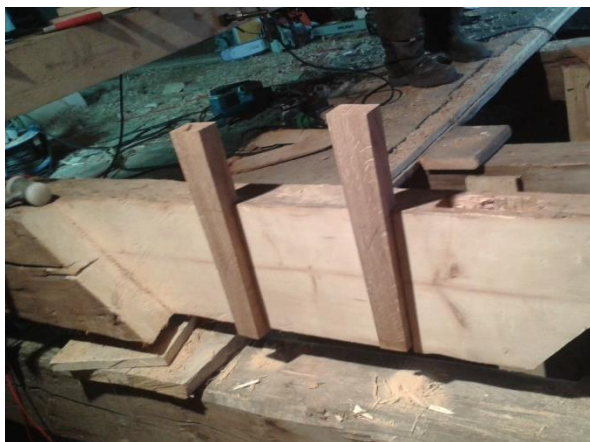
Obr. 67 Realizace nově navrženého spoje v barokním krovu kostela v Červené Vodě (pohled na přípravu spoje před sesazením)
