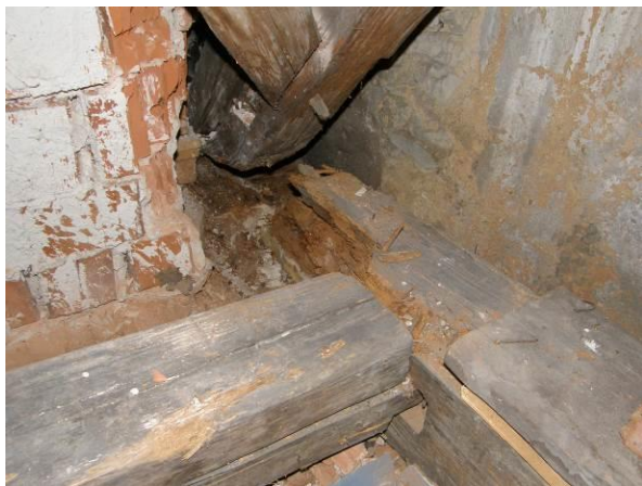
Obr. 56 Deformace zhlaví vazného trámu barokního krovu zámku v Lanškrouně
