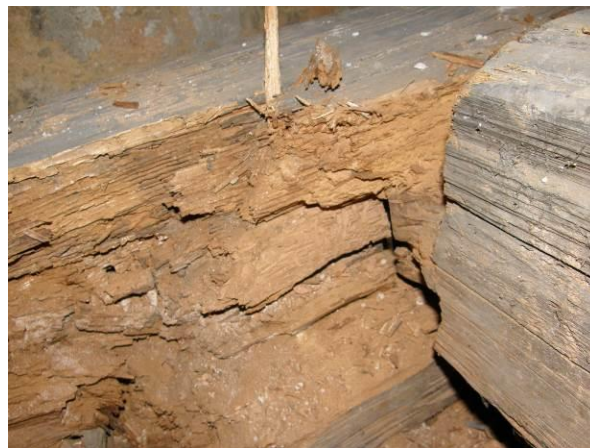
Obr. 57 Detail zhlaví kde došlo k rozkladu dřeva způsobené dřevokaznou houbou hnědého tlení
