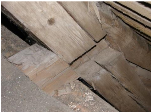
Obr. 7 Záměrné změny – chybějící spoj
