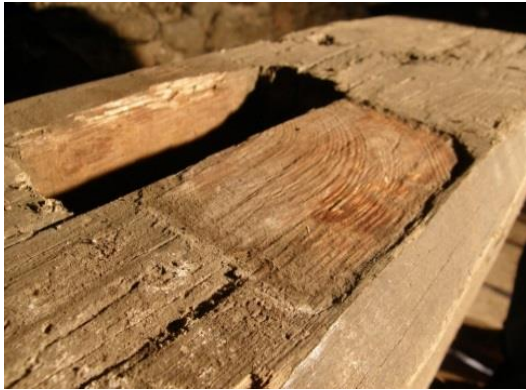
Obr. 1 Tlak kolmo k vláknům (původní pata sloupku)
