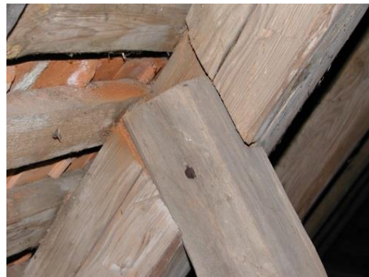
Obr. 8 Záměrné změny – nevhodně modifikovaný spoj
