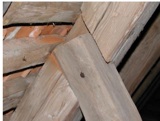
Obr. 8 Záměrné změny – nevhodně modifikovaný spoj
