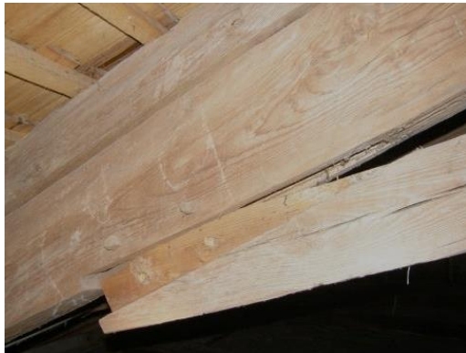
Obr. 5 Částečně rozpojený spoj
