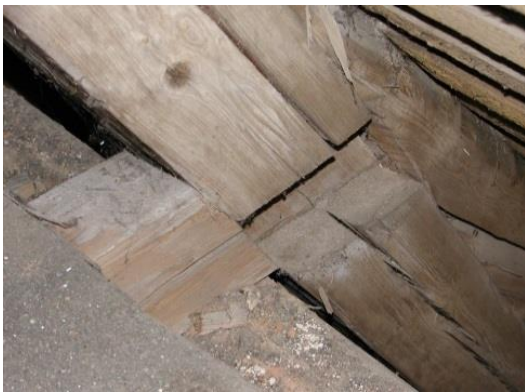
Obr. 7 Záměrné změny – chybějící spoj
