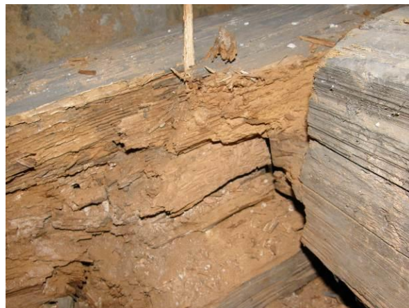
Obr. 57 Detail zhlaví kde došlo k rozkladu dřeva způsobené dřevokaznou houbou hnědého tlení
