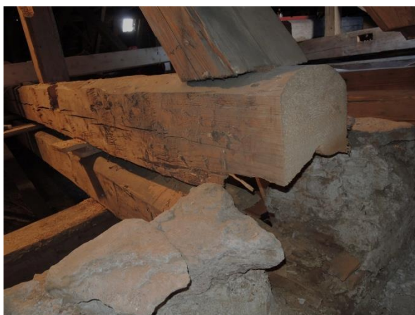
Obr. 66 Detail zhlaví, kde došlo k rozkladu dřeva dřevokaznou houbou hnědého tlení
