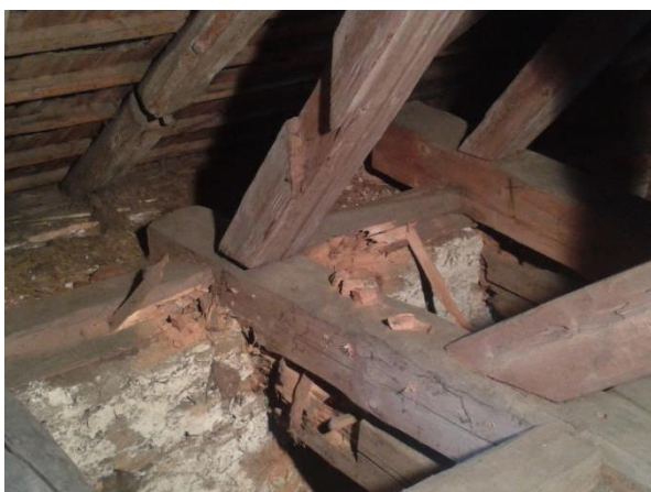
Obr. 65 Deformace zhlaví vazného trámu barokního krovu kostela v Červené Vodě
