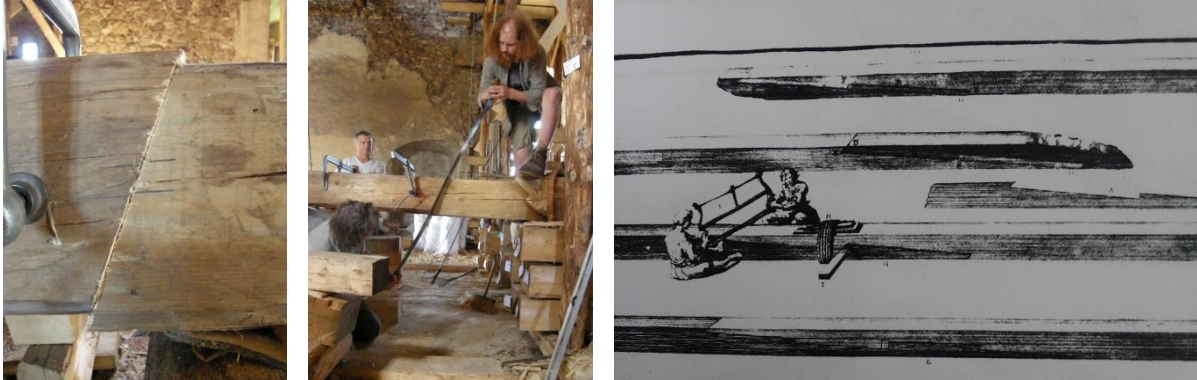
Obr. 46 a) Spasování čela spoje, b) prořezávání ruční pilou c) prořezávání čel spoje v díle [33]
