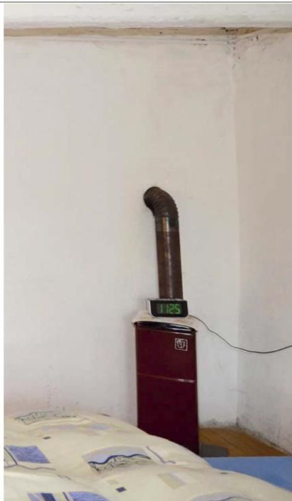
Obr. 02 Kamna ZORA 10 instalovaná v menší světnici domu č. p. 81. Foto J. Koudelová, 2014.
