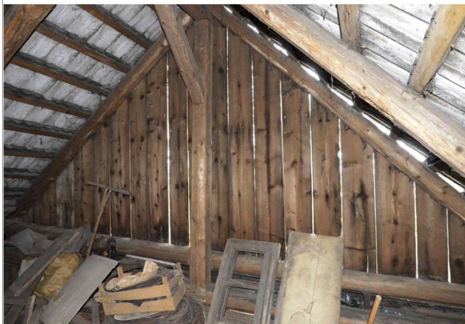
Obr. 04 Západní štít ze strany půdního prostoru stodoly u č. p. 1003. Foto O. Schejbal, 2013.
