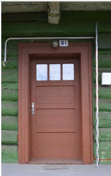
Obr. 03 Venkovní strana dveří ve východním průčelí domu č. p. 81. Foto J. Koudelová, 2013.
