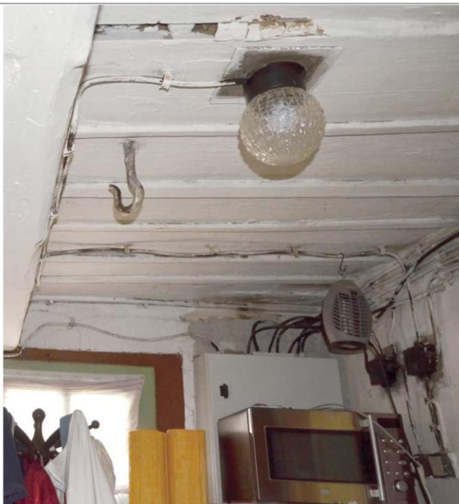
Obr. 02 Vybraný úsek elektroinstalace v jihovýchodním rohu síně domu č. p. 81. Foto J. Koudelová, 2014.
