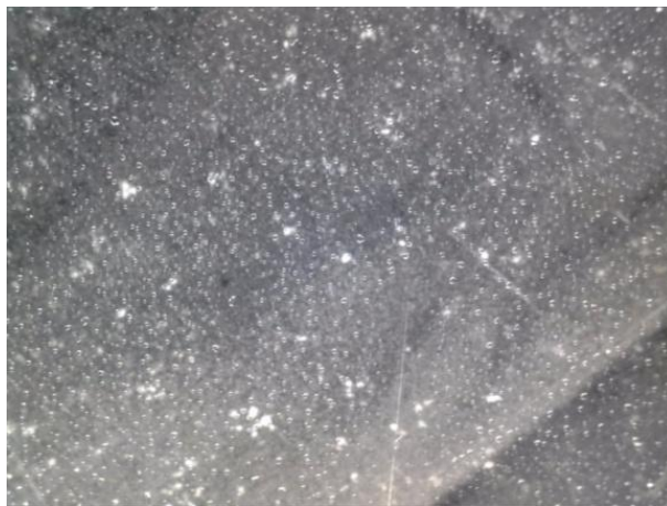
Obrázek 43 Koroze krycího skla
