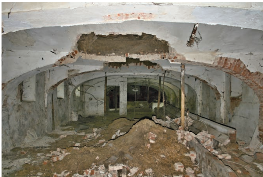
Obr. 14. Milešov, č. p. 74, postupná destrukce kleneb ovčína. Foto David Skalický, 5. 9. 2014.
