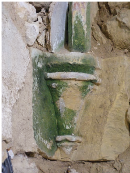
Obr. 15. Chouč, kostel sv. Kateřiny – poškození povrchu kamenné konzole v úsledku působení vlhkosti včetně mikrovegetace. Foto: Lucie Radová, 2010.
