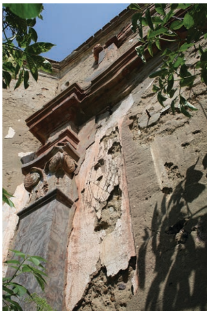
Obr. 23. Všestudy, kostel sv. Michaela, interiér, detail rozpadajícího se torza architektury rokokového hlavního oltáře z umělého mramoru. Foto: Vít Honys, 2014.
