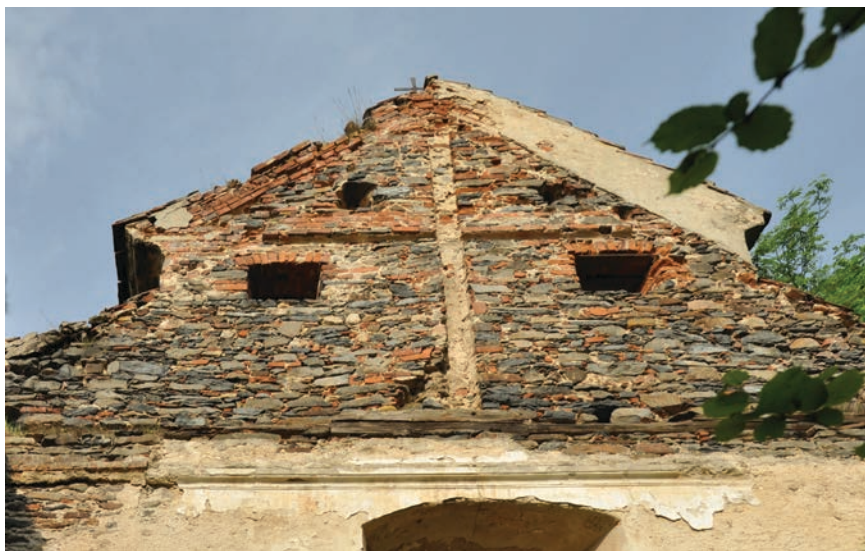
Obr. 27. Bílý Kostelec, kostel sv. Havla, loď, na vnitřní straně štítu lodi se v režném zdivu dochoval otisk hambalkového krovu s věšadlem a částečně hmotově dochovaným zazděným vazným trámem. Otisk je jediným dokladem zaniklého krovu kostela, ve hmotě štítu jsou navíc rozeznatelné dvě stavební fáze. Foto: Táňa. Nejezchlebová, 2012.
