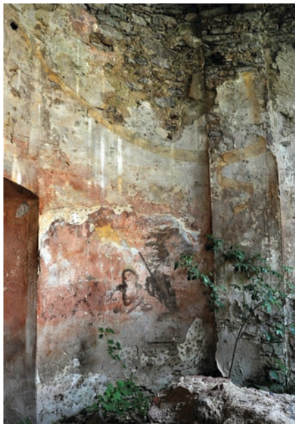
Obr. 20. Bílý Kostelec, kostel sv. Havla, závěrová strana presbytáře, díky degradaci svrchní šablonové malby z 19. století se na povrchu omítek projevují torza originální figurální a ornamentální výzdoby presbytáře, v závislosti na celkovém havarijním stavu objektu však dochází k rychlé ztrátě detailů a ploch maleb. Foto: Táňa Nejezchlebová, 2012.
