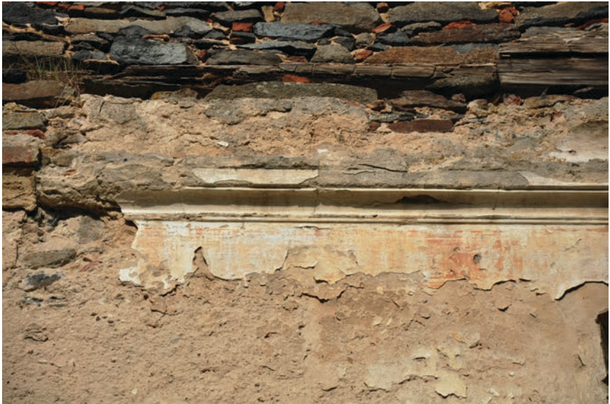
Obr. 14. Bílý Kostelec, kostel sv. Havla, interiér lodi, z plochého stropu kostela se dochovaly pouze omezené úseky štukového profilovaného fabionu s relikty barevných nátěrů ve více vrstvách. Foto: Táňa Nejezchlebová, 2012.
