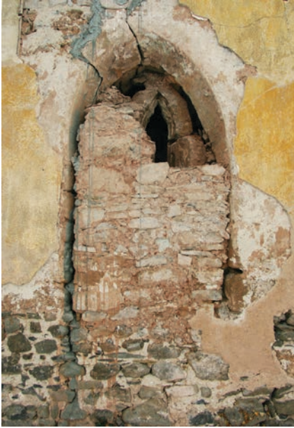
Obr. 13. Lubenec – Libyně, kostel sv. Jiří, závěrový bok presbytáře, při částečné destrukci zazdívky gotického okna bylo ve světlém otvoru odhaleno kamenné ostění s jeptiškou, pocházející zřejmě z počátku výstavby kostela v 1. polovině 14. století. Foto: Táňa Nejezchlebová, 2011.
