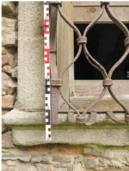
Obr. 33: Detail spínané okenní mříže s přiloženým měřidlem (Horní Slavkov – okres Sokolov, děkanství čp. 178; foto J. Chaloupka, 2014).
