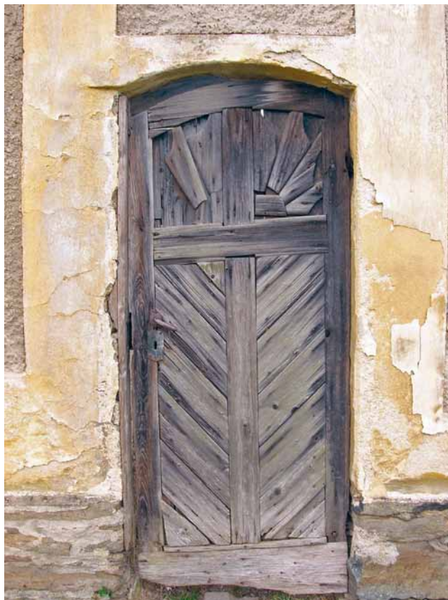
Obr. 2: Paprscitě uspořádaná vrchní část prkenného obkladu svlakových dveří je již neúplná, o její původní podobě však zatím ještě není nutné pochybovat. S dokumentací dochovaného stavu ovšem nelze otálet (Palič – okres Cheb, hospodářská budova statku; foto A. Schubert, 2007).
