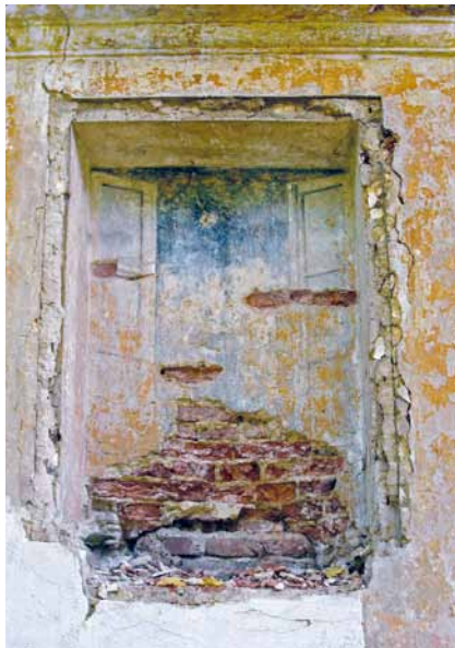
Obr. 17: Mezi zvláště cenné výplně okenních otvorů patří také iluzivní okna. Jsou značně ohrožena chátráním, není proto vhodné odkládat jejich dokumentaci (Praha 5 - Košíře, usedlost Cibulka; foto A. Schubert, 2010).
