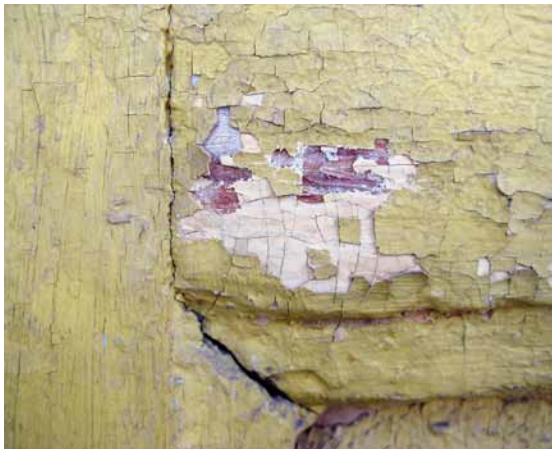
Obr. 19: Pod odprýskaným stávajícím nátěrem je často možné rozpoznat pozůstatky starších nátěrů (Praha 6 - Střešovice, dům čp. 969; foto A. Schubert, 2013).
