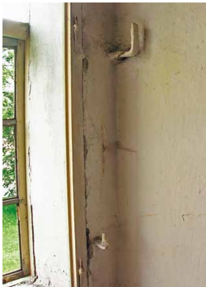
Obr. 7: Při prohlídce zkoumané stavby je nutné věnovat pozornost i pozůstatkům odstraněných výplní okenních otvorů. V tomto případě jde o osazovací rám vnitřního okna, stěžež závěsu okenice a hák pro osazení závory (Toužim – okres Karlovy Vary, zámek; foto A. Schubert, 2010).
