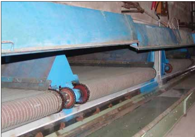
Obr. 5: Vyústění drátěných pásů ze sušicích komor
