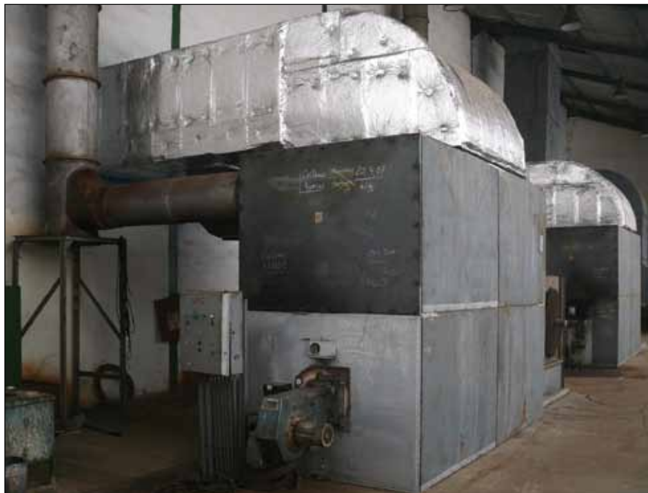
Obr. 6: Izolace topných kanálů u výměníku topného zdroje
