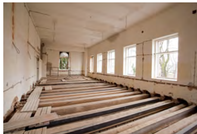
Strop napadený dřevomorkou. Foto: Archiv SZM.
