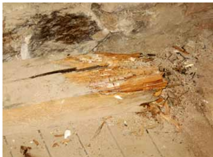
Obr. 2: Zhlaví trámu zcela zničené dřevomorkou
