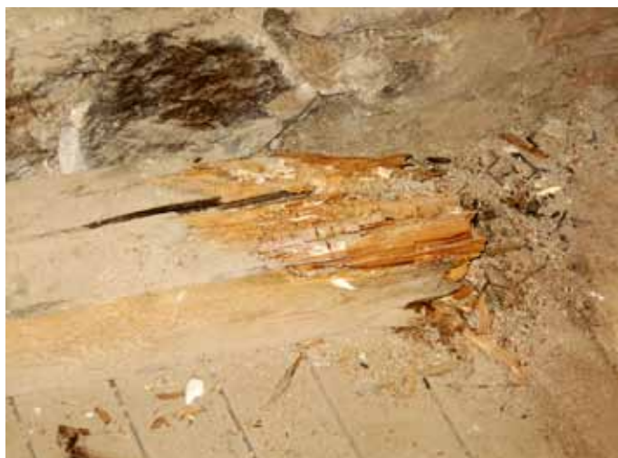
Obr. 2: Zhlaví trámu zcela zničené dřevomorkou
