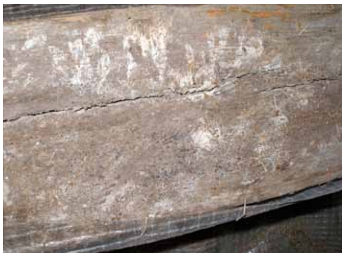
Obr. 4: Porost mycelia dřevokazné houby na povrchu dřevěného trámu
