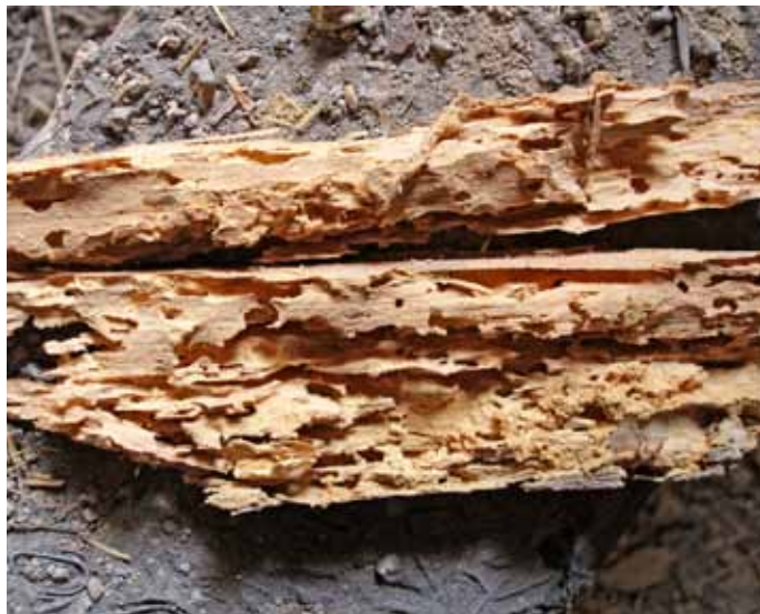
Obr. 7: Destrukce dřeva larvami tesaříka krovového
