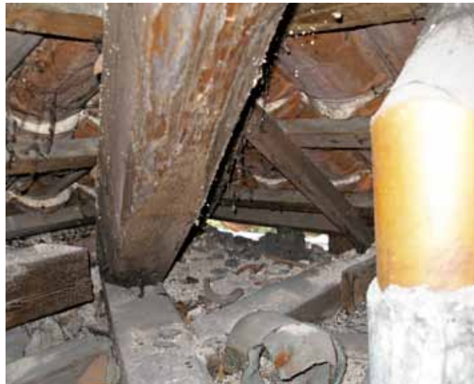
Obr. 8: Zbytky stavebního materiálu v prostoru krovu
