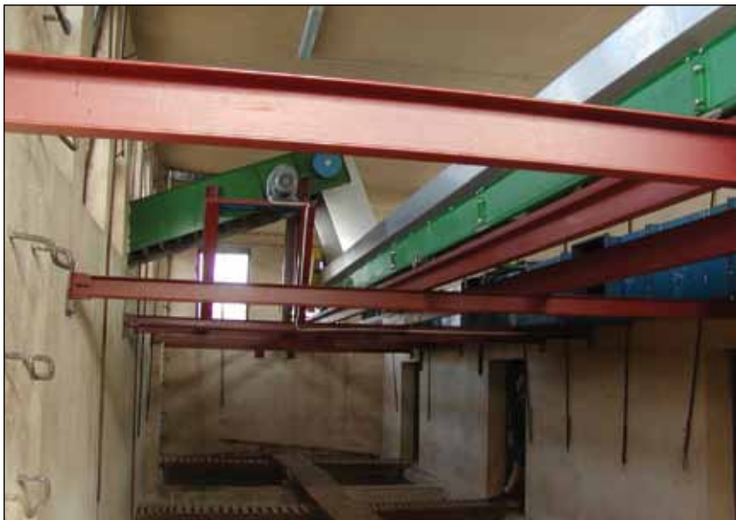
Obr. 3: Rozprostírací pás je umístěn v horní části násypné komory na příčných nosnících.
