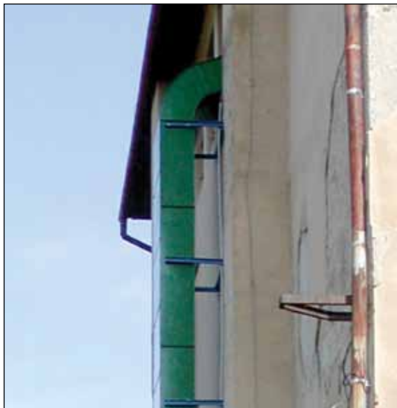
Obr. 1: U komorové sušárny je nainstalován kapsový dopravník pro načesání chmel
