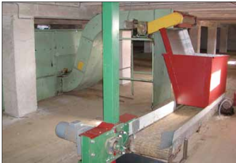
Obr.9: Vyústění pásu z klimatizační jednotky, mezizásobník usušeného a klimatizovaného chmele a dopravní pás k násypce lisu
