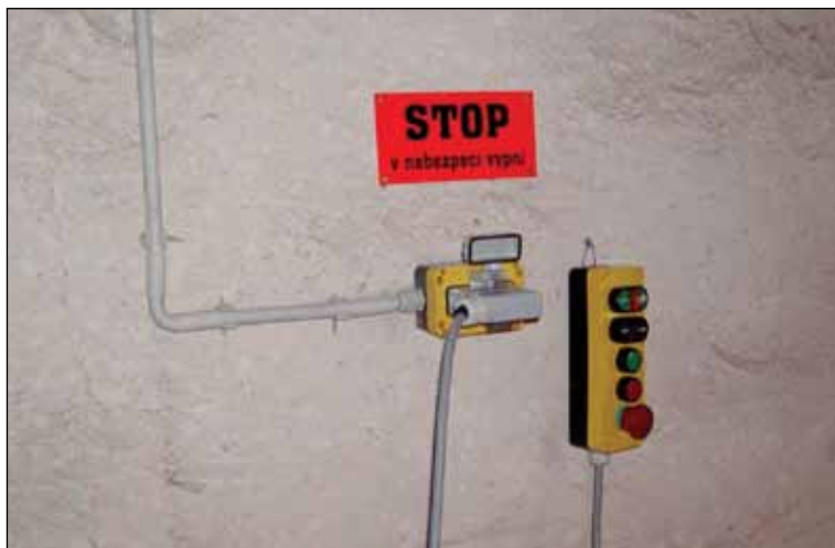
Obr. 10: Ukázka části ovládacích a zabezpečovacích prvků
